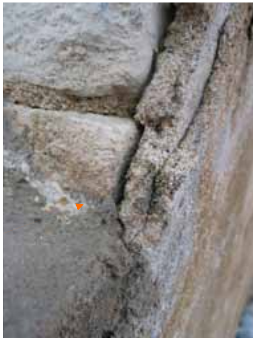
slika 6. Žbuka u sljubnici između dva kamena segmenta
