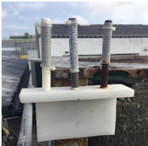
Figura 18. Productos de corrosión o ganancia de masa adheridas a las probetas de la estación 3. (Paz Oñate & Velez Mendoza, Elaboración Propia)
