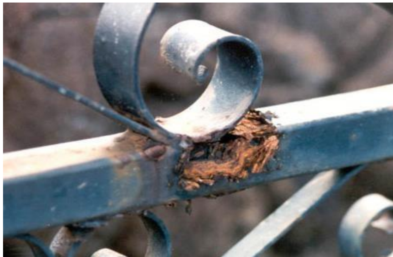
Figura 6. Ejemplo de corrosión localizada. Arqhys.com (2018) Imagen tomada de: http://www.arqhys.com/articulos/corrosion.jpg
