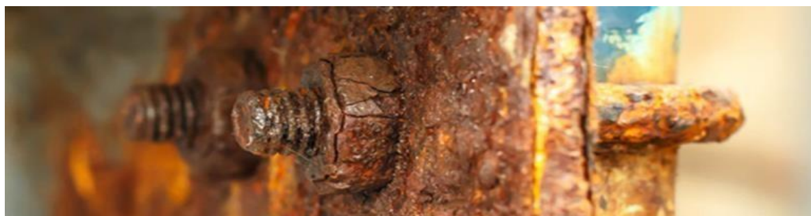
Figura 2. Ejemplo de deterioro de un metal por corrosión. Destek, E. (2021) recuperado de: https://www.ekoldestek.com/cephe-onarim-izolasyon-ve-korozyon-onleme-hizmetleri/
