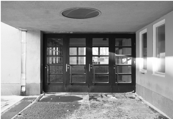
Kuva 83. Koulun pääsisäänkäynti. Lipan alapinnan rappaus hilseilee paikoitellen.
