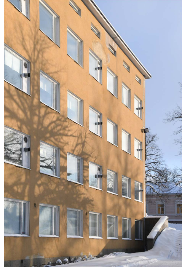
Kuva 80. Osa luokkahuoneiden tuuletusikkunoista on ummistettu ja niitä lävistää luokkahuonekohtaisen ilmanvaihdon putkia. Ikkunoiden kunnostukseen käytetty lateksipohjainen maali on rapistuneensa ennestään heikentänyt ikkunoiden kuntoa.
