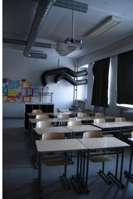
Kuva 86. Kaikkiin luokkiin on sijoitettu luokkahuonekohtaiset ilmanvaihtolaitteet vain vähän ennen koulun jäämistä tyhjilleen. Nyt ilmanvaihtolaitteista ovat enää jäljellä poistoilmaputket, kun itse laitteet on viety Hämeenlinnan muihin kouluhin.
