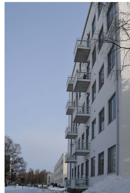
6 Kuva 51. Luoteisjulkisivun noppamaiset ulokeparvekkeet istuvat hyvin funktionalismin tyyliin. Toisaalta näitä parvekkeita voi olla vaikeaa tunnistaa uusiksi, eikä rakennukseen alun perin kuuluneiksi rakenteiksi.
