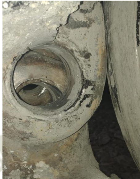
Figura 36. Caída de pin y rotura de zapata
