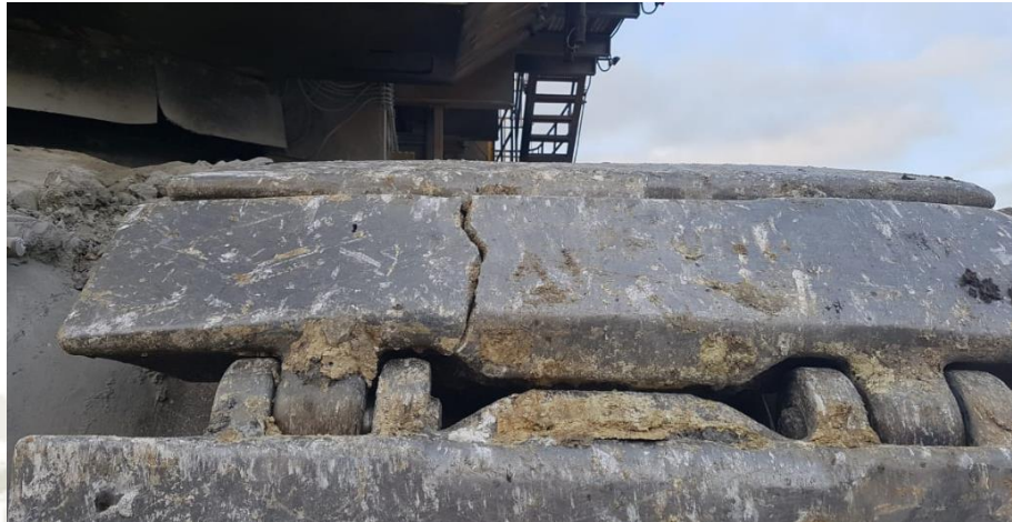
Figura 34. Rotura de zapata
