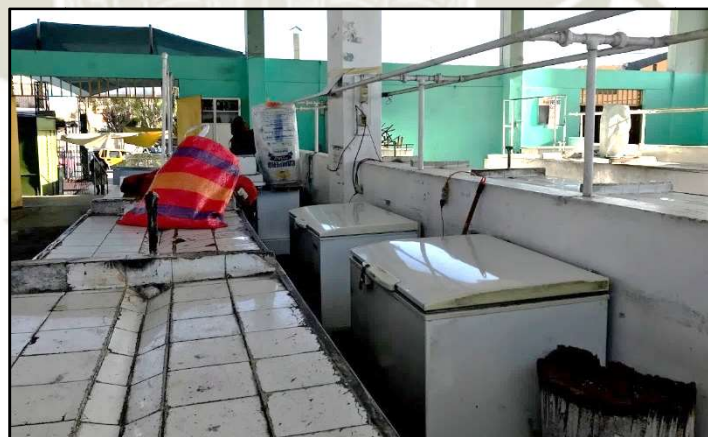
Fotografía 11 Estado de las instalaciones del Mercado Manuel Prado.
