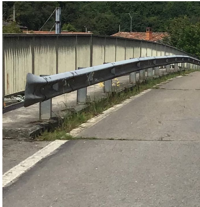
Ilustración 12- Barrera de protección
