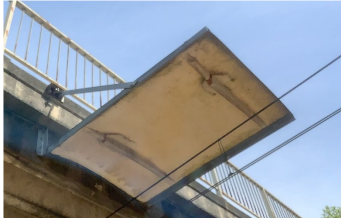
Ilustración 7- Protección de catenaria a la derecha del tablero
