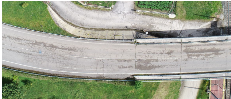
Ilustración 35- Daños sobre el pavimento
