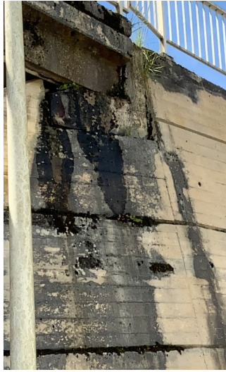
Ilustración 34- Humedad en estribo 2
