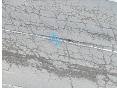
Ilustración 22- Marca sobre la carretera
