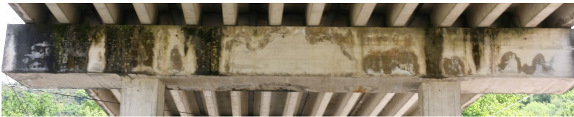
Ilustración 4- Cargadero en pila 3
