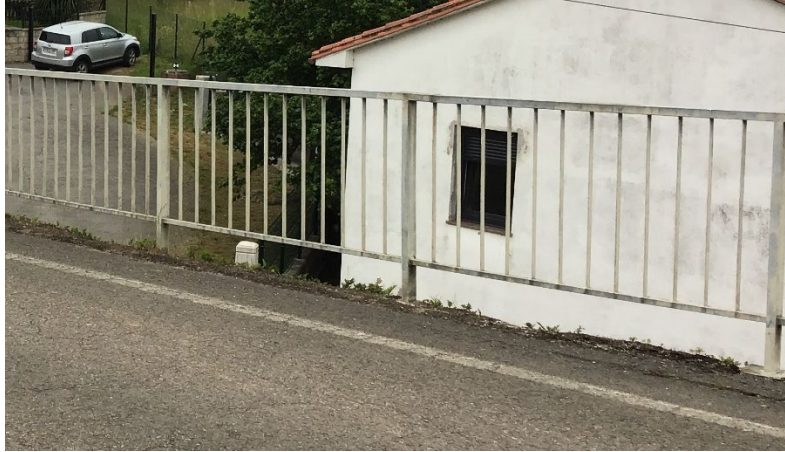
Ilustración 13- Barandilla de protección
