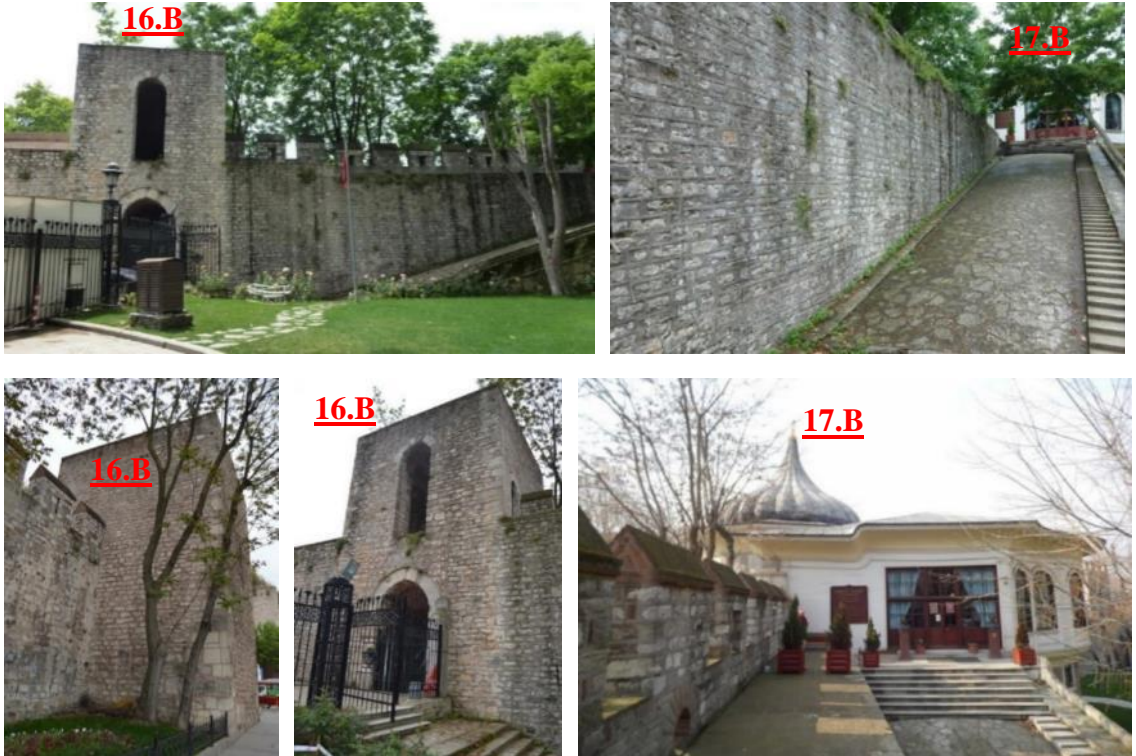
Şekil 3.162. 16 nolu burç ile 17 nolu burç (Alay Köşkü) arasındaki sur içinden görünüşler (Soyal).
