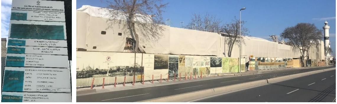
Şekil 2.40 Sur-i Sultani'nin Marmara deniz surları kısmındaki güncel restorasyon çalışmalarından genel görünüm (Soyal, 2019). 27
