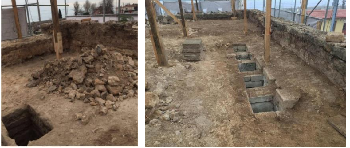
Şekil 3.50. Otluk Kapısının restorasyon çalışmaları sırasında ortaya çıkarılan ocak bacası ve yağ mazgallarına ilişkin genel görünüm (İRAM, 2015).
