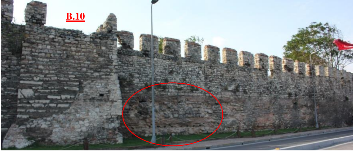
Şekil 3.366 B.10 ile B.11 arasındaki sur duvarında, Bizans dönemi yapı kalıntısının izleri ve üzerindeki Osmanlı dönemi duvar örgüsüne ilişkin genel görünüm (Soyal, 2016).
