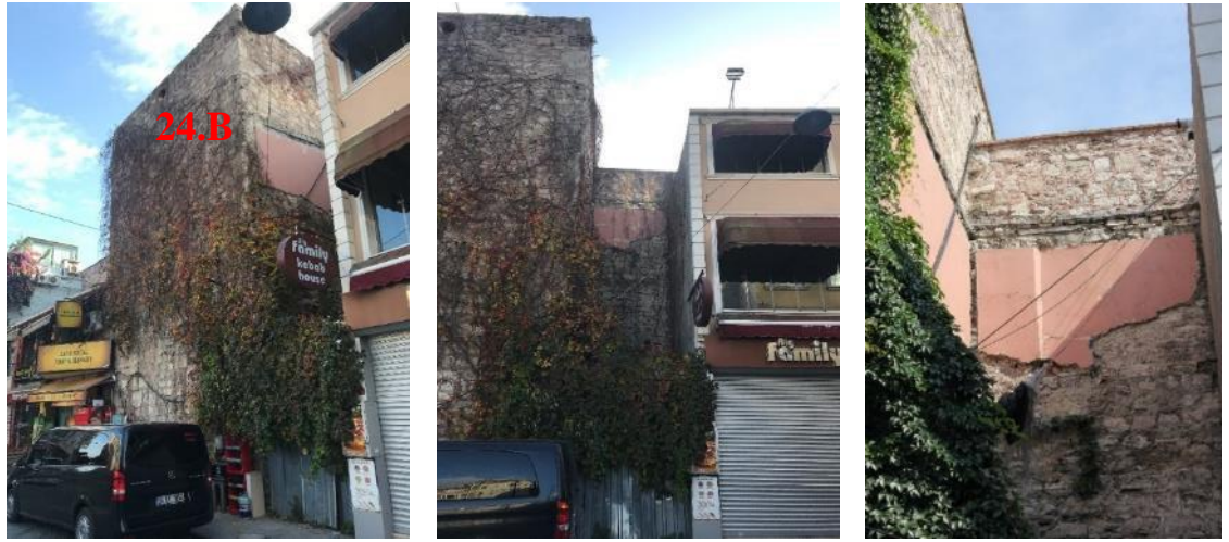
Şekil 3.249: 24 nolu burç ve sur duvarının birleştiği köşedeki boşluk alan (Soyal, 2019, 2016)
