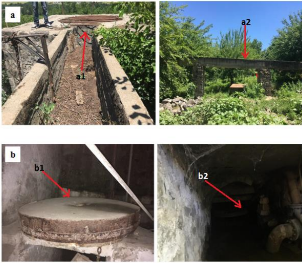
Şekil 6. Heysel Bahçeleri Değirmen V; a) Üstten görünüm a1; Depolama haznesi a2; Değirmen Kanalı, b) b1; Değirmen taşı ve çarkı, b2; Depolama haznesi
