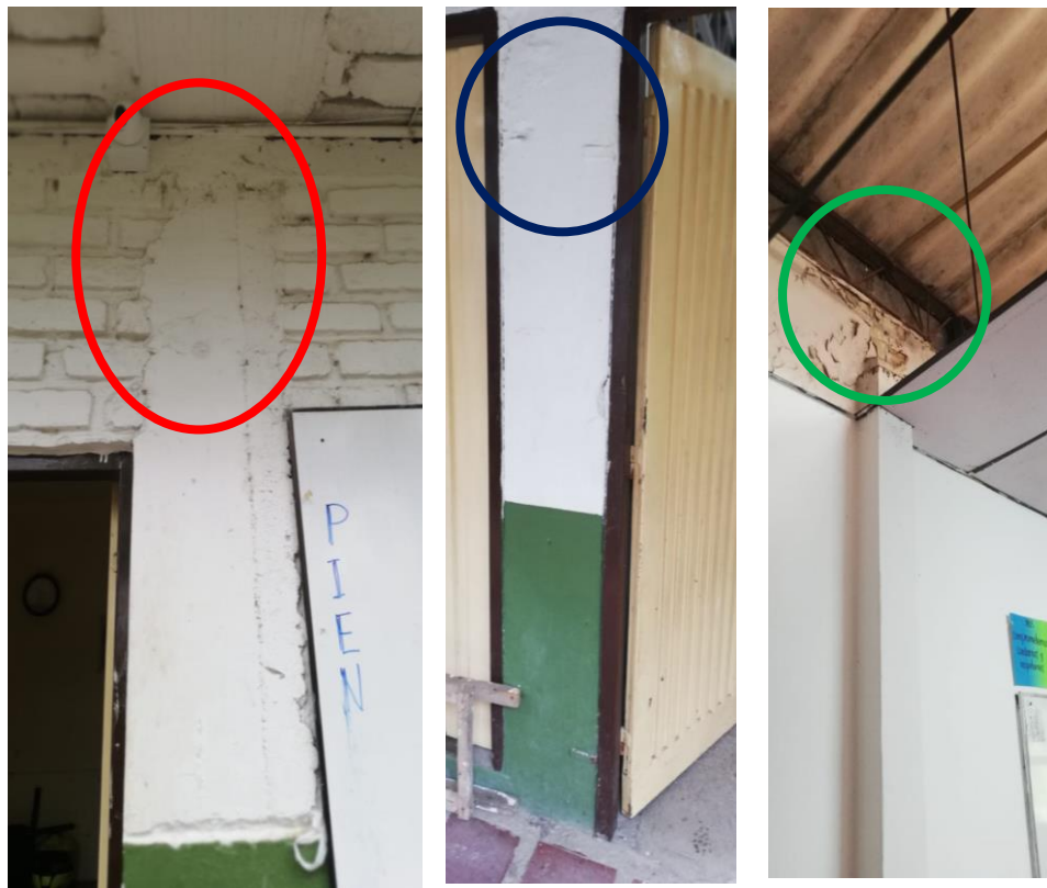
Figura 8: Problemática columnas Fuente: Propia
