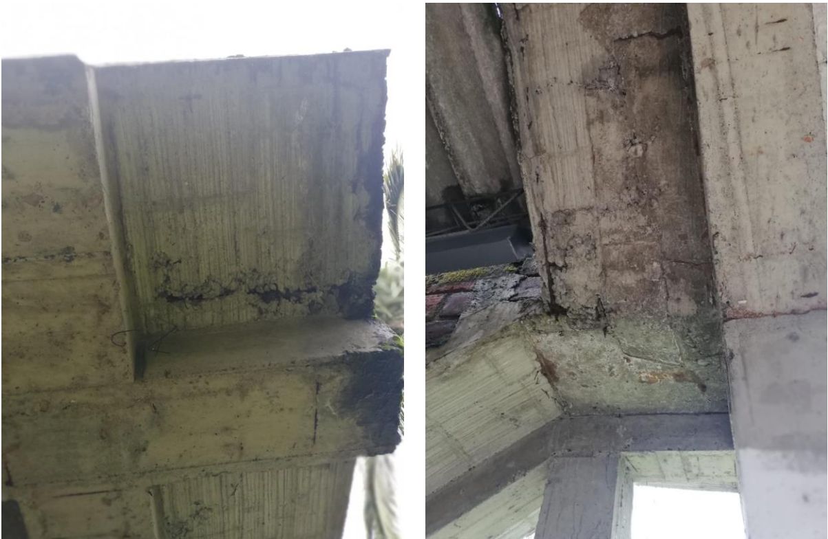
Figura 6: Acero expuesto. Fuente: Propia
