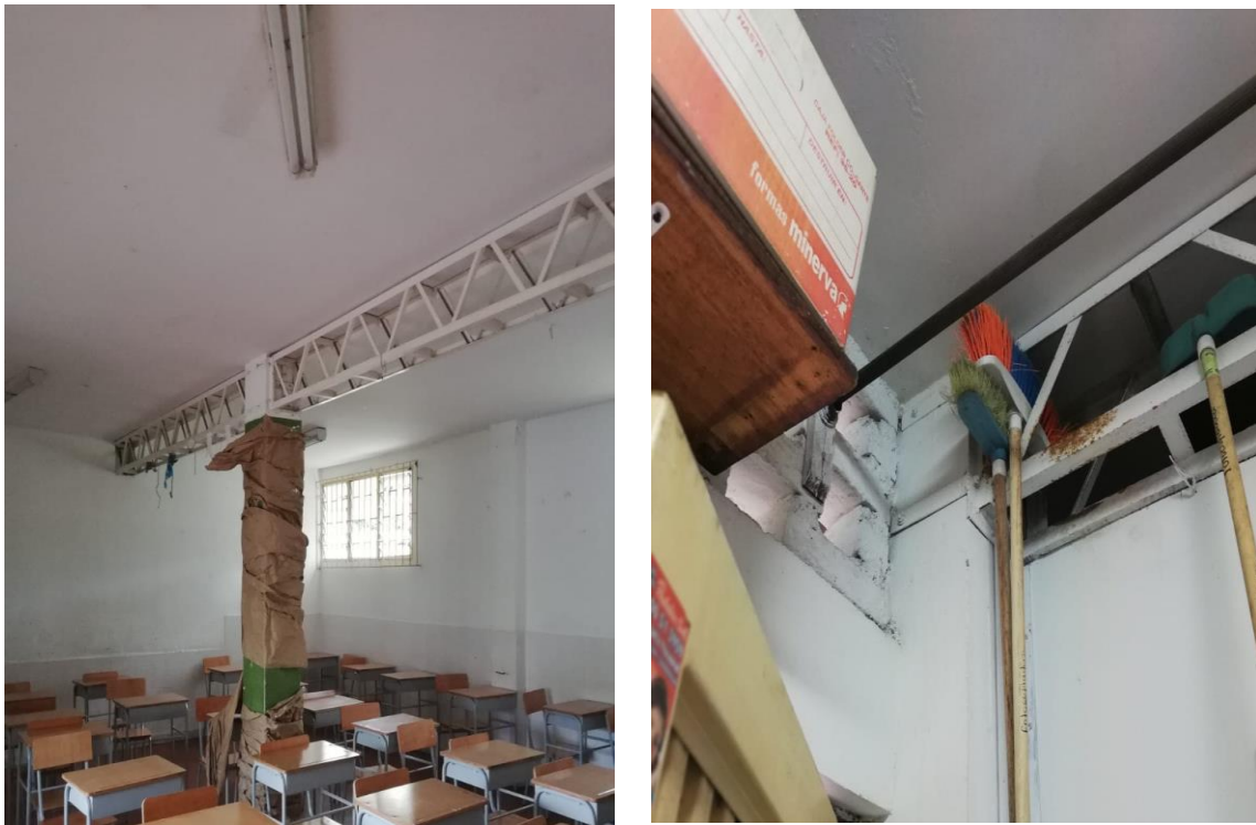
Figura 11: Elementos metálicos Fuente: Propia
