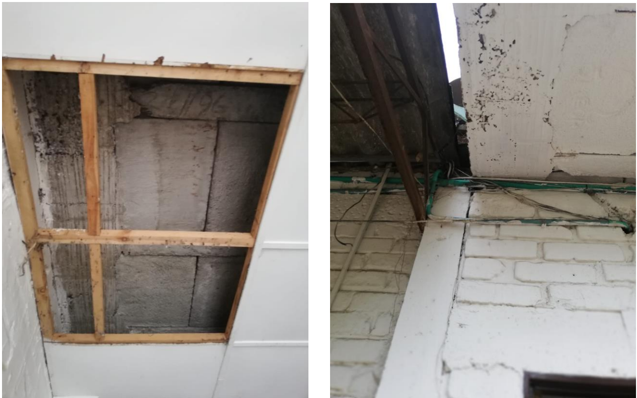
Figura 7: Deterioro vigas Fuente: Propia
