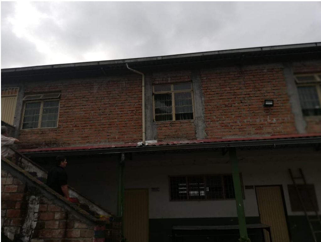
Figura 3: Deterioro fachada Fuente: Propia
