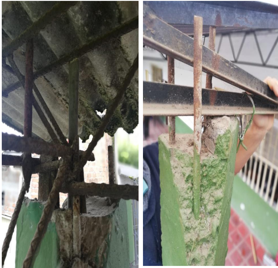
Figura 12: Elementos metálicos Fuente: Propia
