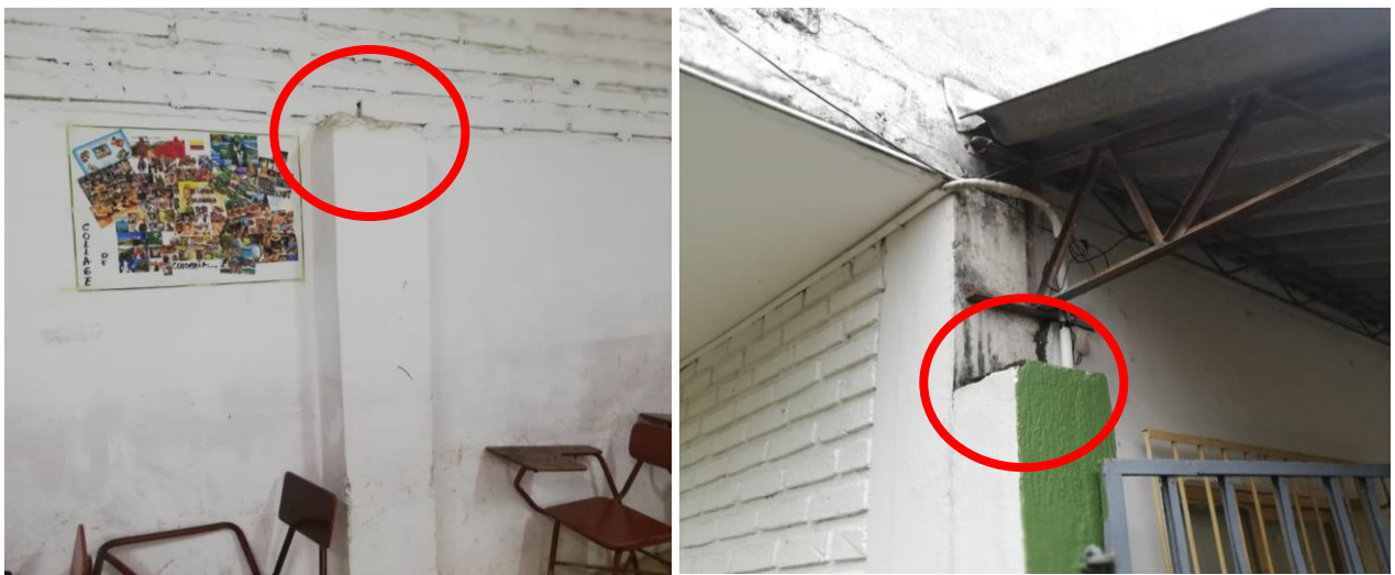
Figura 9: Columnas cortas Fuente: Propia
