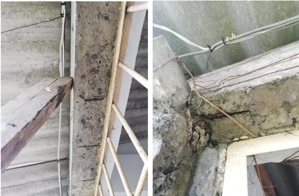
Figura 4: Acero expuesto. Fuente: Propia
