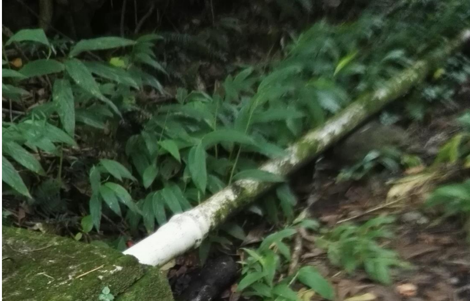
Foto 3 Tubería desde el tanque de rebose al desarenador.
