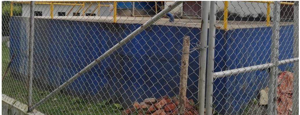
Foto 6 Tanque de almacenamiento.
