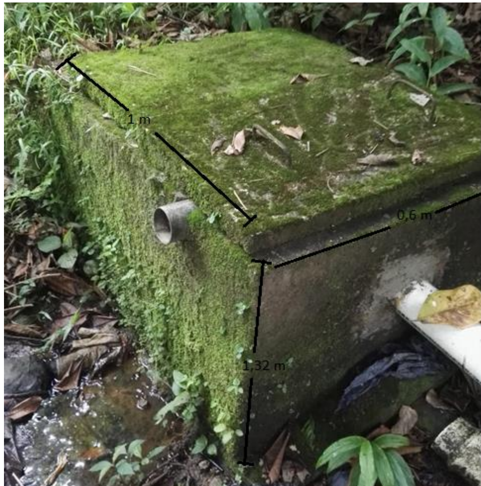
Foto 2 Tanque de rebose.
