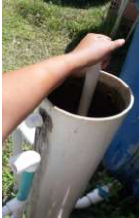
Retro lavado de filtros
