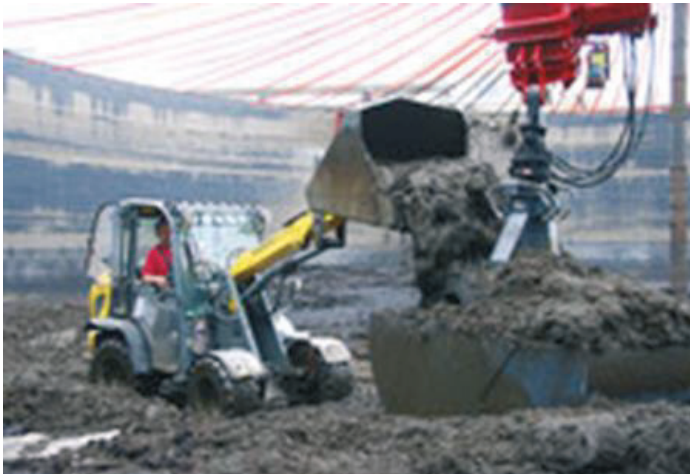
Abb. 2 Fermenter-Reinigung in einer Biogasanlage
