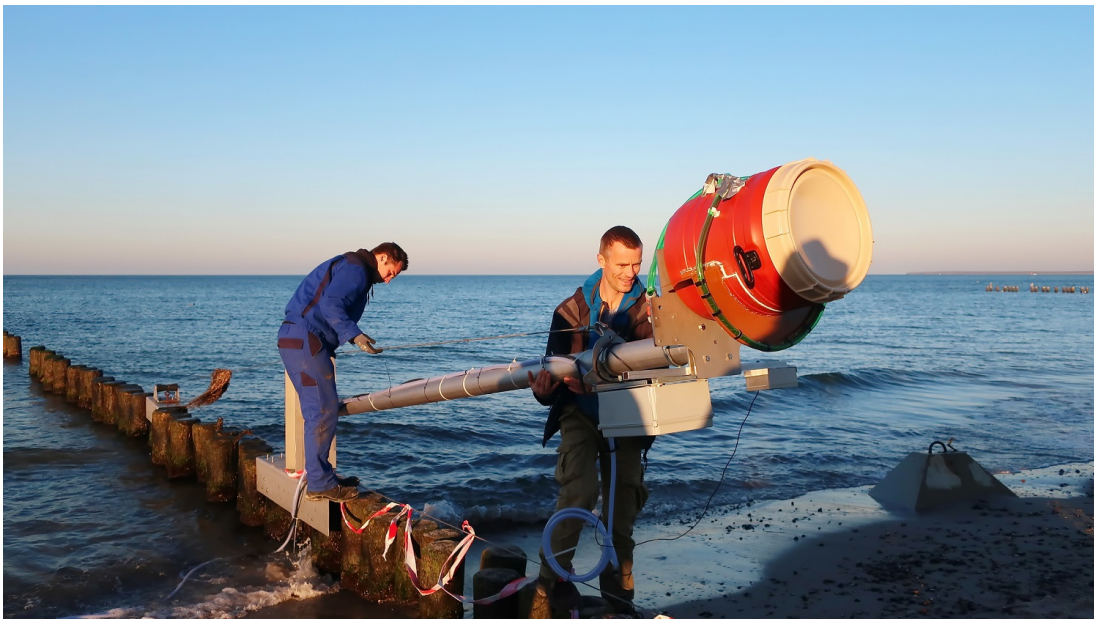
ABBILDUNG 3.6: Installation der Messtechnik am geklappten Messpfahl (Foto: Christian Kaehler).
