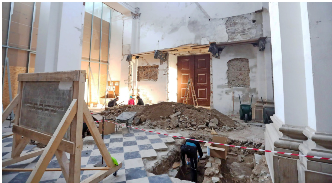
Koprška stolnica med obnovo. V ospredju plošča z napisom Vergerijev. Foto: T. Primožič, FPA
