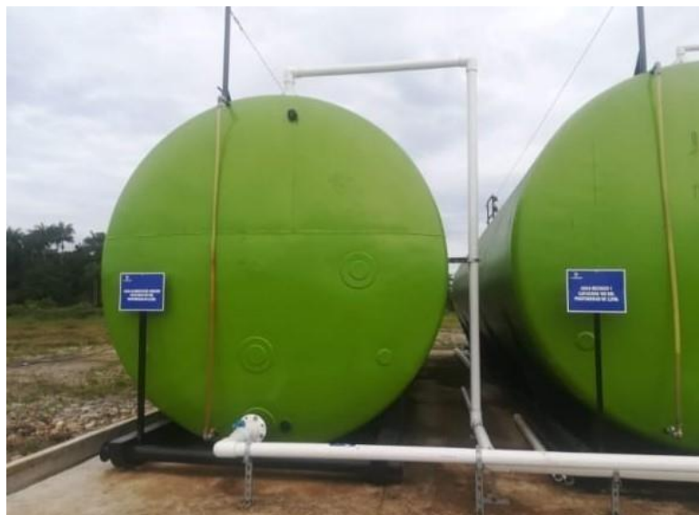
Figura 7. Tanques de almacenamiento.
