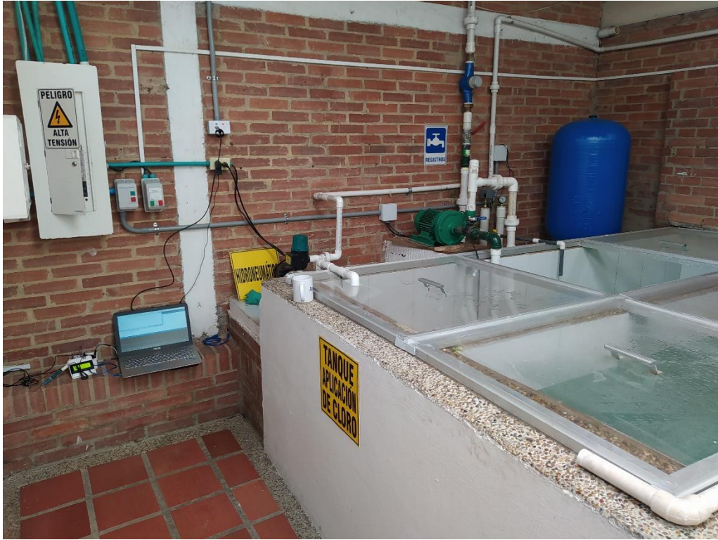
Figura 22. Tanque de agua potable de la planta de tratamiento.
