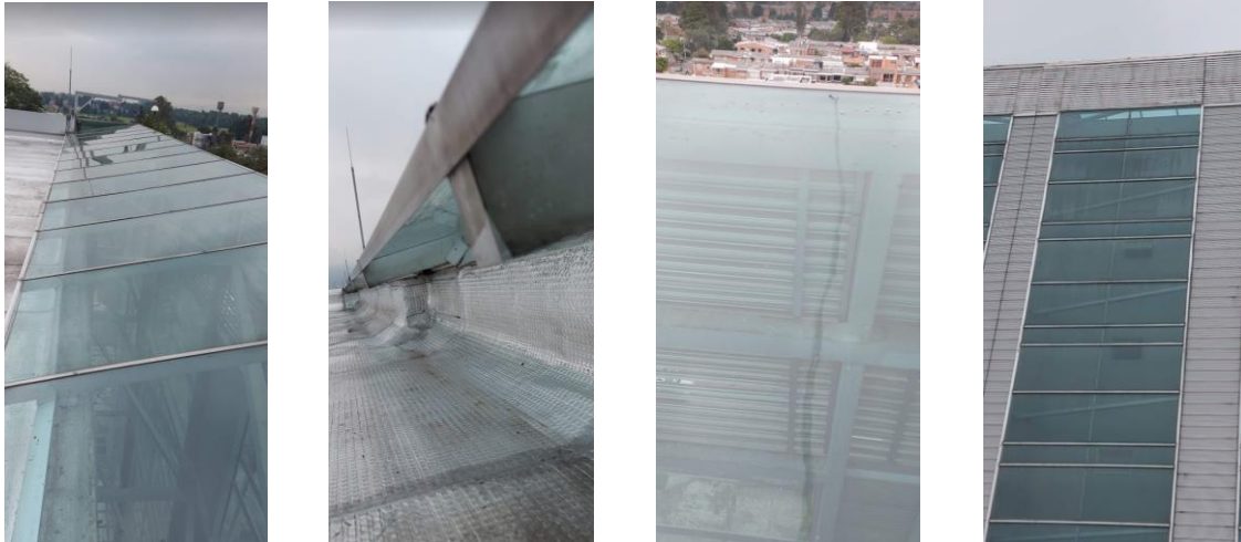
Ilustración 47. Remate cubierta en cristal con reventilación obstruida
