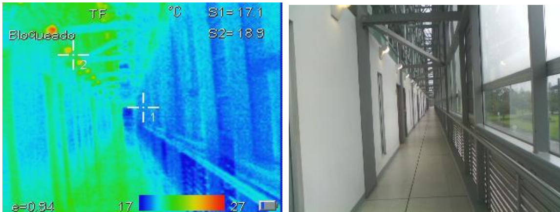
Ilustración 14. Termografías en corredores efecto Stack. Fuente: Elaboración propia
