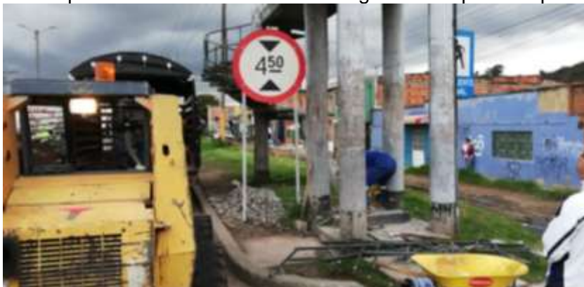
Imagen 8: Implementación de medidas de seguridad en puentes peatonales.
