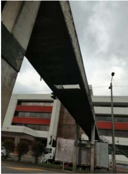
Imagen 5: Placa desplomada en el puente peatonal
