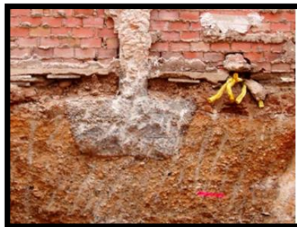
Ilustración 8: Descalce de una cimentación vecina durante excavación.
