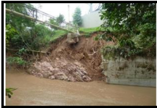
Ilustración 11: Cárcava de erosión, margen izquierda quebrada Mensulí.
