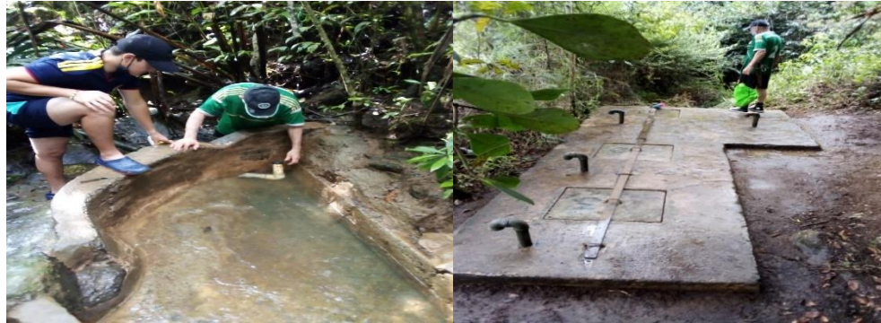
Ilustración 11 Bocatoma, tanques de almacenamiento
