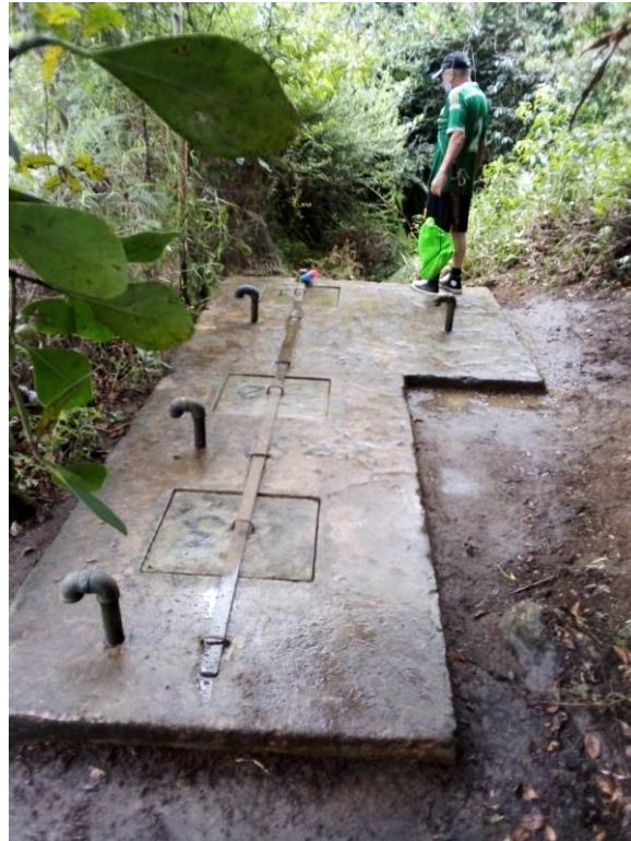
Ilustración 2 Tanques de Almacenamiento
