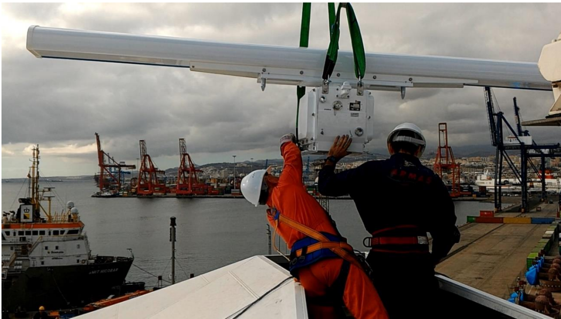
Ilustración nº 42: Instalación del radar
