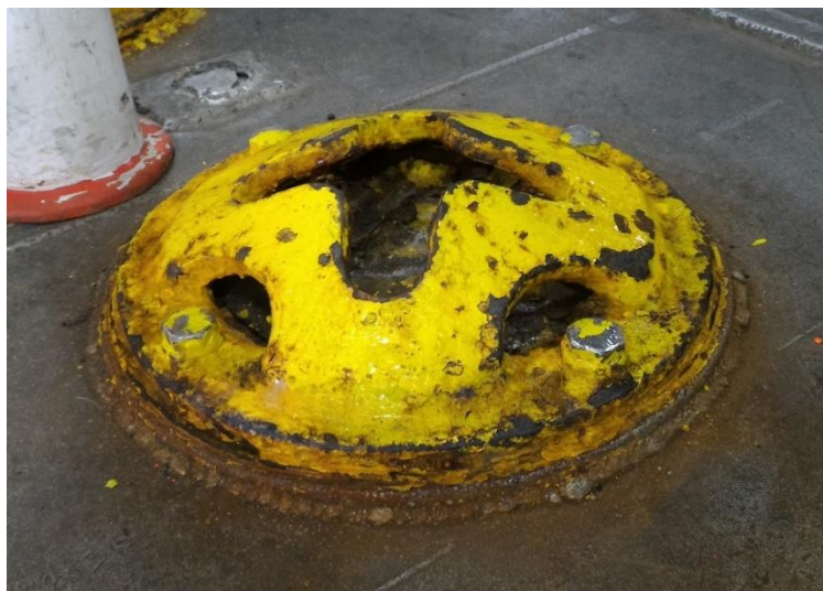
Ilustración nº 50: Pie de elefante deteriorado
