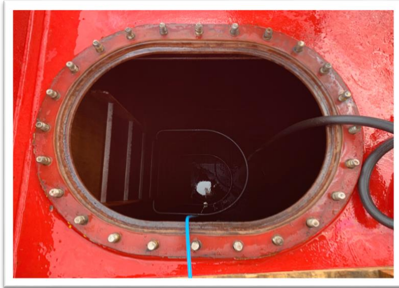
Ilustración 12. Ventilación y acceso al tanque
