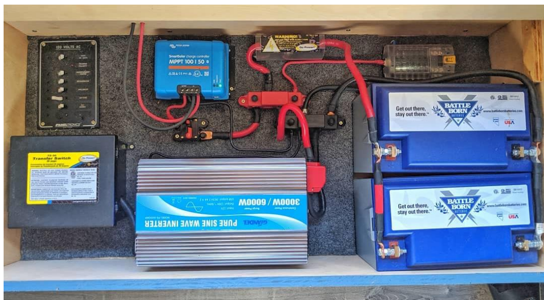
Figura 17. Aspecto físico de una instalación fotovoltaica aislada con acumulación de media potencia. Fuente: [21].
