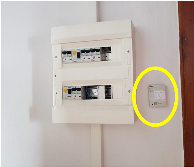
Fig. 34 Imagen de la colocación del datalogger (en amarillo).
