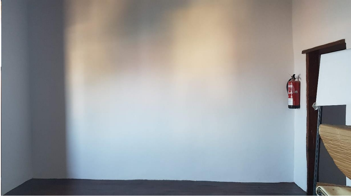
Fig. 27 Representa la pared que presentaba estar afectada por humedad y el extintor, una parte del riesgo al que se somete la colección almacenada.
