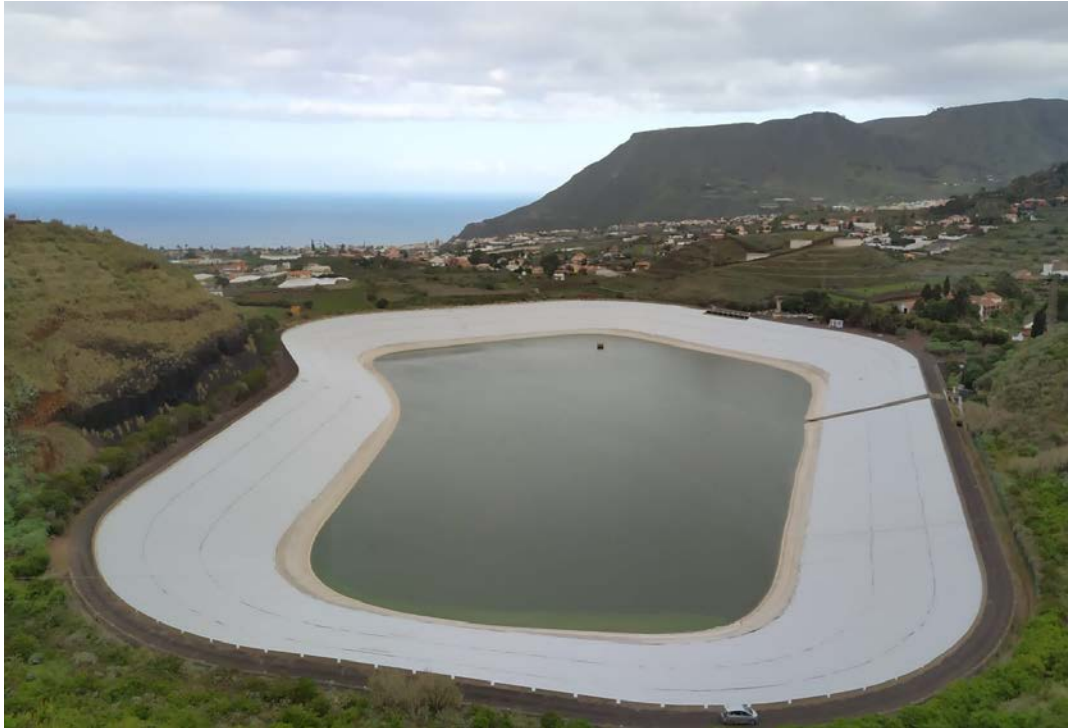
Figura 3. Vista de la balsa de Valle Molina tras la re-impermeabilización parcial, nótese el cambio de tonalidad entre la lámina original en el fondo y la nueva en el anillo superior.
