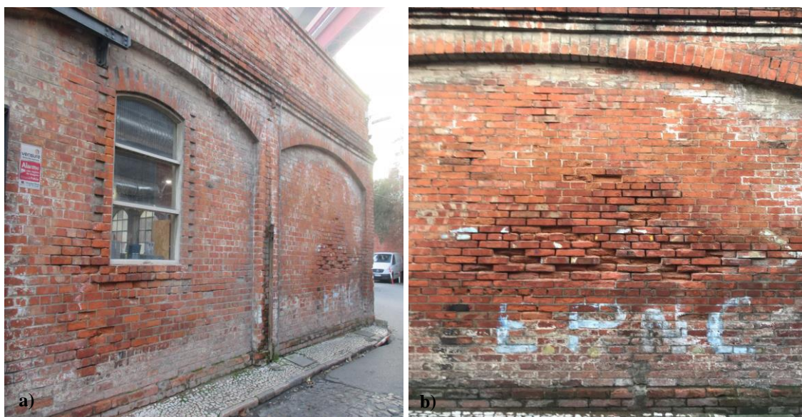
Figura 2.5. Eflorescências salina com desagregação de tijolos nas Docas em Lisboa
