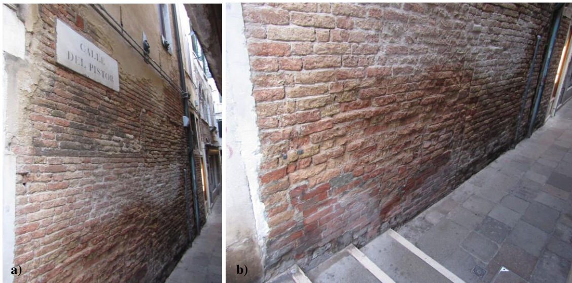
Figura 2.4. Eflorescências salina com esfoliações e fragmentações de tijolos em edificação em Veneza
