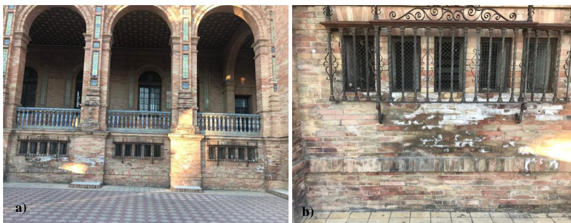
Figura 2.2. Manchas de umidade e eflorações na estrutura de tijolos da Praça da Espanha, Sevilla
