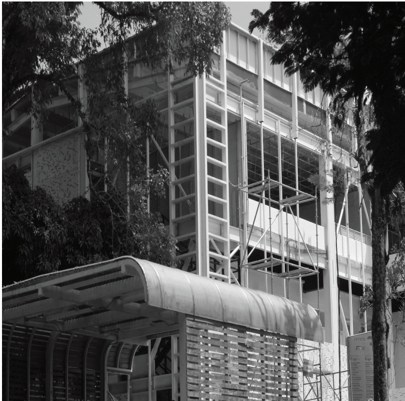
Anexo 3. Edificio de la Facultad de Ciencias de la Educación en Construcción a 12 de julio de 2018
