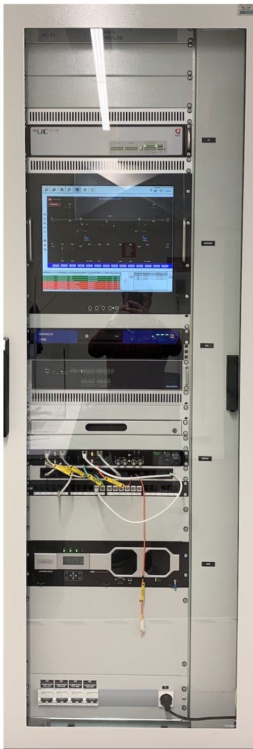
Figura 4.3: Armário do Smartlab SAS contendo equipamentos do SPCC
