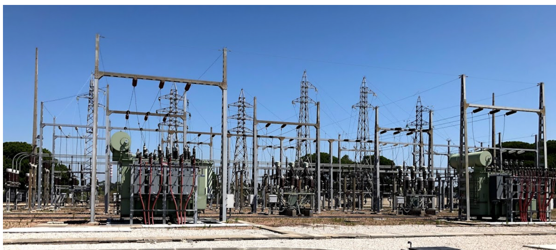
Figura 2.1: Parque Exterior de Aparelhagem de uma Subestação AT/MT do Operador da Rede de Distribuição E-Redes
