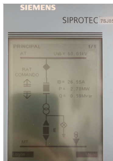
Figura 5.13: Monitor do IED do Painel de Transformador de Potência AT1 em Regime Nominal
