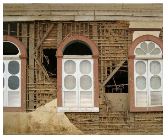
Figura 6: Casarão da praça central de São Luiz do Paraitinga após as inundações. Fonte: Arquivo do IPHAN, 2010.
