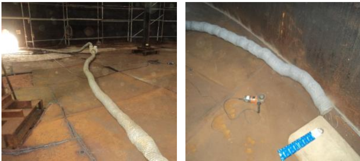
Figura 18– Extração localizada para fumos de soldadura, vapores tóxicos
