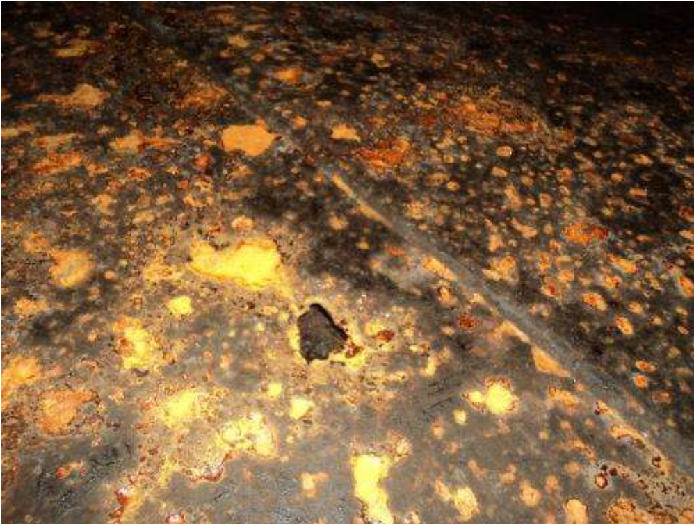
Figura 12- Ponto de corrosão no fundo do tanque
