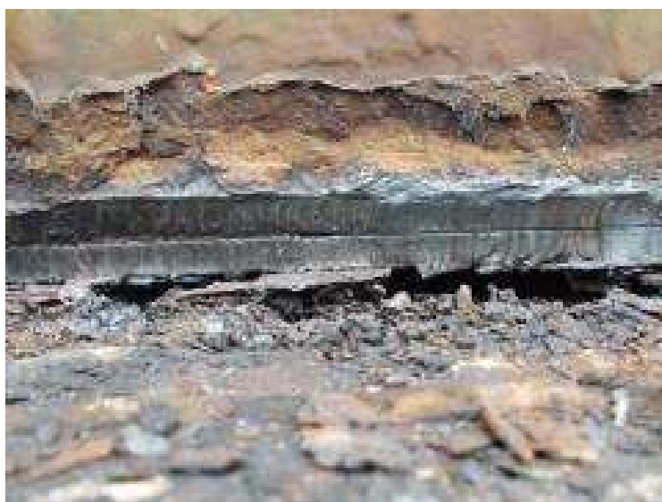
Figura 10– Pormenor chapa do fundo desviada da base de assentamento
