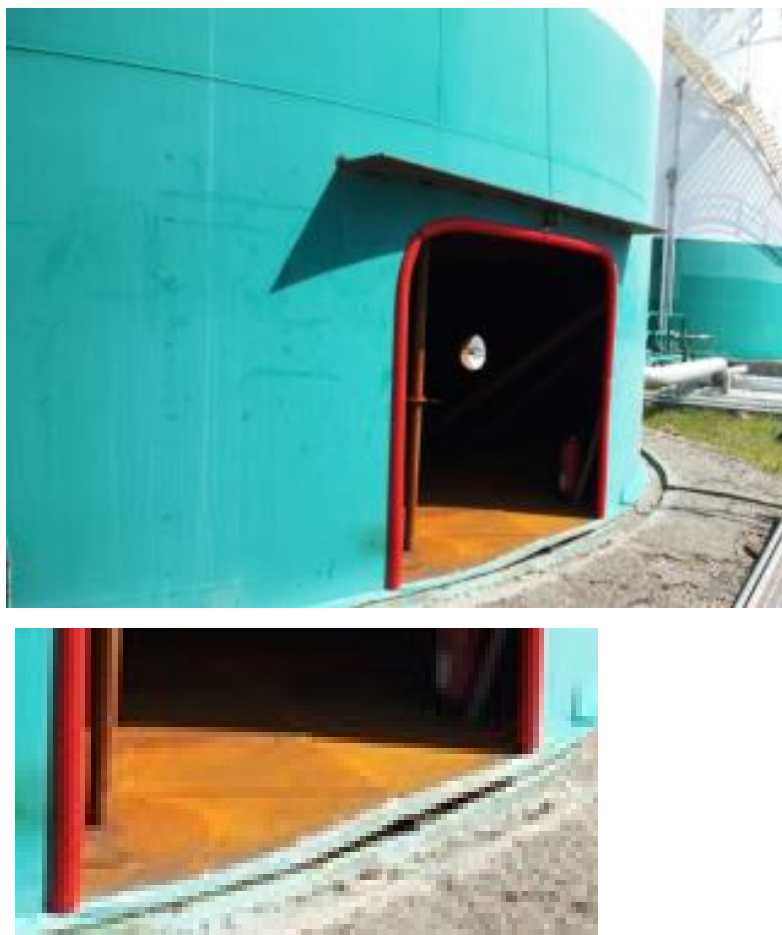
Figura 9– Pormenor intervalo entre a chapa do fundo do tanque e a base de assentamento
