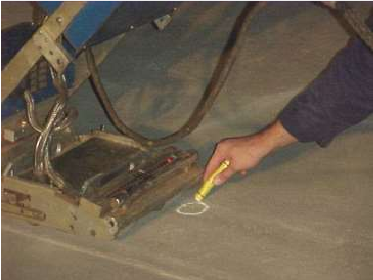
Figura 8- Trabalho de inspecção-ponto de corrosão assinalado
