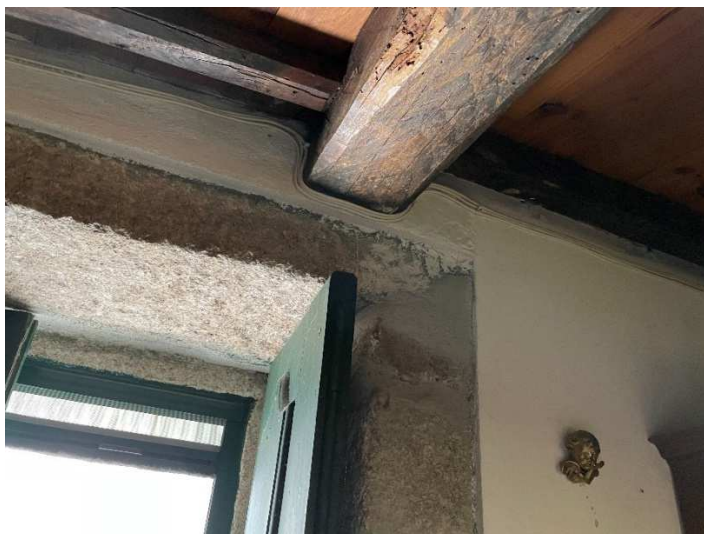
Fig. 4.11 – Pormenor do reboco do pano interior da parede exterior junto à zona do vão
