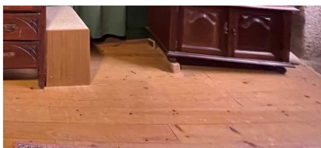
Fig. 4.21 – Pormenor do abatimento do pavimento no piso 1
