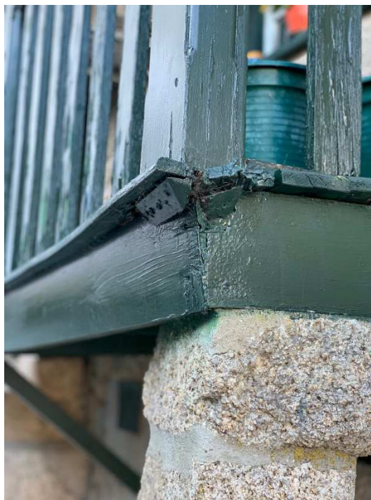
Fig. 4.23 – Pormenor da anomalia na estrutura da varanda
