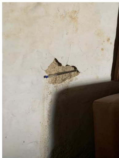
Fig. 4.20 – Degradação do reboco
