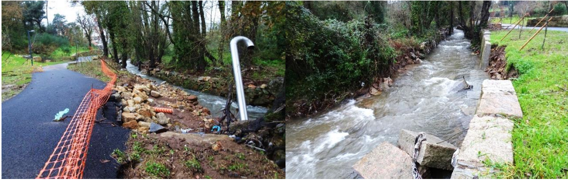
Figura 3.32 – Exemplos de rombos e danos ocorridos no ano 2019, no troço do rio Tinto que atravessa o concelho do Porto (Autor: Diana Fernandes, 20/12/2019)
