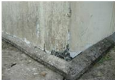
c)canto inferior entre FP e FLD – detalhe da degradação superficial dos blocos hidro (h2)
