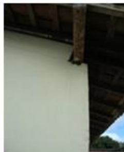
d)FLE -detalhe da fissura no canto superior.
