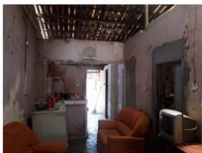
c) sala-cozinha, revestimento em argamassa, mostra retoques posteriores, estrutura de telhado apoiando diretamente sobre parede
