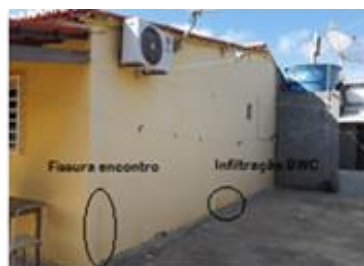
b) parte posterior da casa - detalhe de fissura pilarete de alvenaria e condicionamento do ar.
