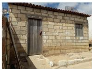
a) fachada frontal embora manchada pelos respingos de chuva os bloquetes não mostra elevado nível de degradação
