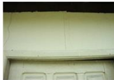
b) FF(NE) – detalhe da fissura no encontro de blocos sobre paredes em verga.
