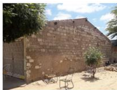
b) fachada lateral revestimento falho, chapisco em argamassa parcial, pouca degradação
