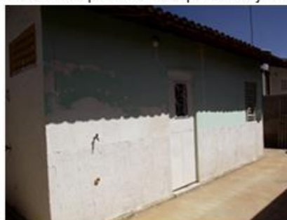
d) posterior- revestimento barra inferior com gesso cola e pintura na barra superior. Manchas de acúmulo de água na base
