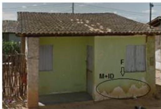
a) fachada frontal mostrando fissuras, manchas e indicativos de degradação
