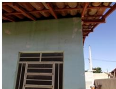
b) fissura inclinada canto superior da parede e descendo para canto esquerdo da janela
