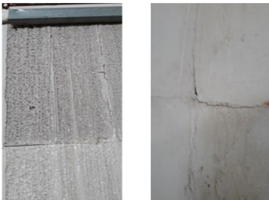
Figura 49-Detalhes da formação de fissura na parede após 10ºciclo
