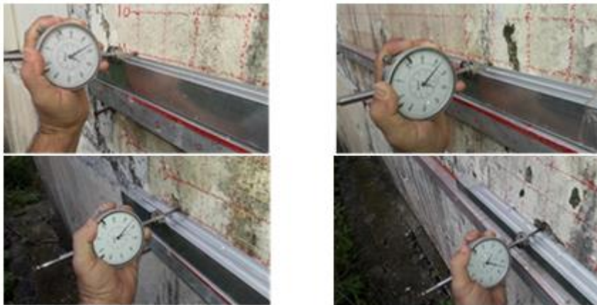
Figura 109-Medições de profundidade no trecho da segunda fiada(bloco standard)
