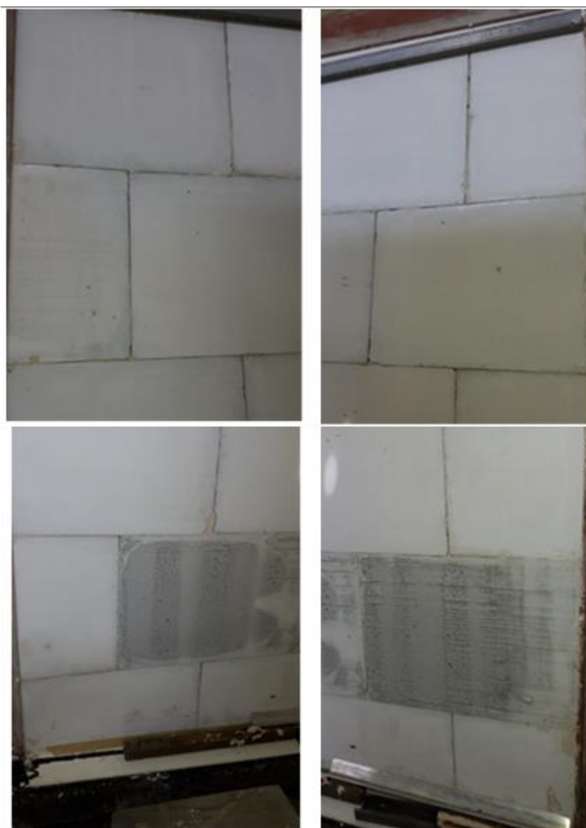
Figura 61-Aspectos da face exposta após 10ºciclo
