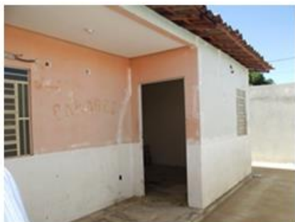
a) fachada frontal, externamente toda em blocos hidro e internamente blocos standard.
