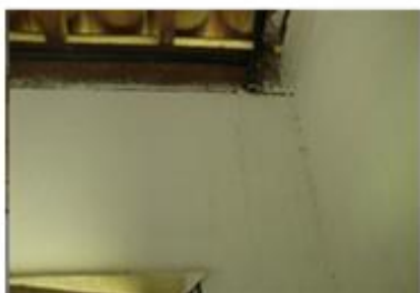
e)PIF – detalhe da fissura junto a porta e no canto no encontro de blocos ao lado fissura central(C5)
