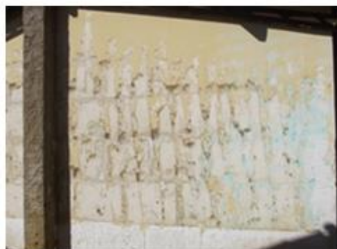
c) perda de aderência e degradação acentuada nos blocos standard
