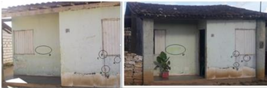
a) fachada frontal indicativos de degradação da pintura localizada e pequenos destacamentos entre blocos e acréscimo de mancha (tonalidade e região).
