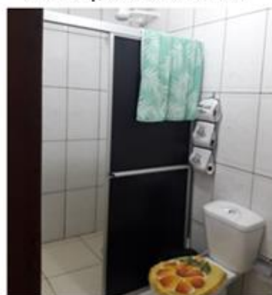
f) BWC social, revestimento cerâmico piso a teto, fonte de infiltração pelo piso na parede exterior
