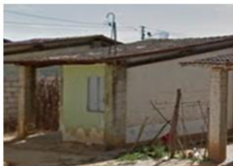
b) fachada lateral mostrando perda da pintura sobre bloco hidro e desgaste blocos standard
