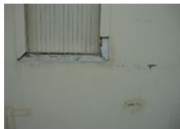
d) FLD(ESE) – detalhe degradação contorno da janela; degradação no encontro dos blocos da 2ª e 3ª fiada
