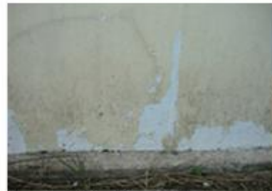
d) canto inferior FP – detalhe degradação da pintura e degradação superficial dos bloco hidro
