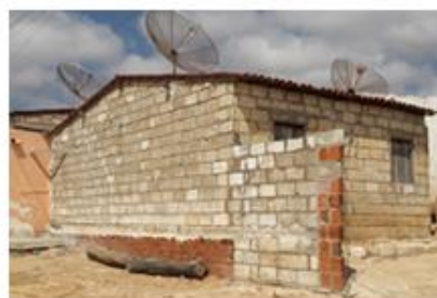
b) fachada lateral, embasamento em tijolos cerâmicos com certo grau de degradação muito maior que os bloquetes.
