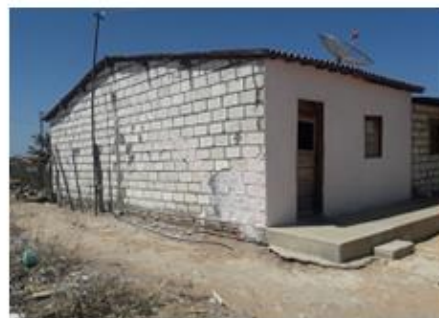
b) fachada lateral sem revestimento, detalhe de embasamento de tijolos cerâmicos degradados
