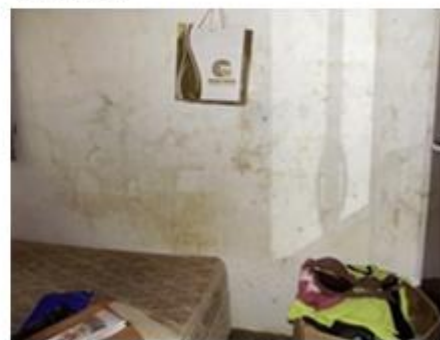
f) Detalhe manchas diferenciais entre fiadas, menor na 1ª fiada
