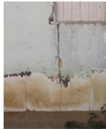
b) detalhe de fissura no canto da janela manchas e degradação dos blocos
