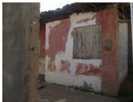
b) Perdas acentuadas 1ª fiada quase intacta no pilar de alvenaria argamassado
