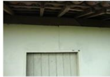
f)FP- fissura sobre porta; encontro de blocos sem verga, recebendo carga
