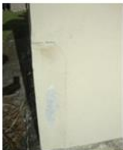
c)FLE – fissura no canto inferior junto a parede da fachada frontal.
