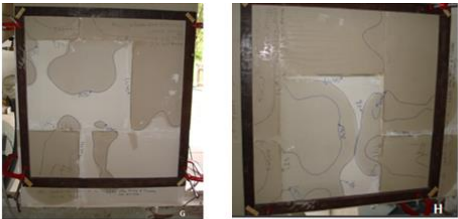
Figura 79-Teste de estanqueidade parede de blocos standard com selador acrílico e tinta acrílica
