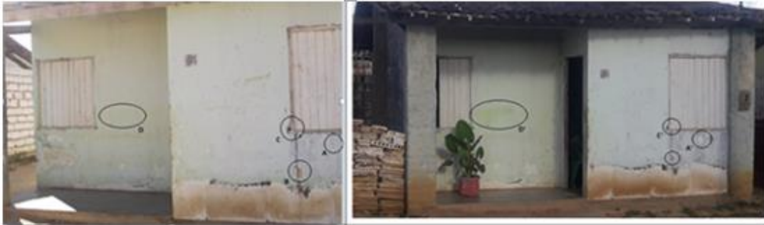
a) fachada frontal- mostra crescimento muito pequeno nos indicativos de degradação da pintura e destacamentos entre blocos, embora mostra acréscimo de manchas.
