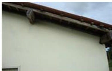
b)FLE – detalhe da fissura no canto superior onde recebe carga da cobertura, na empena
