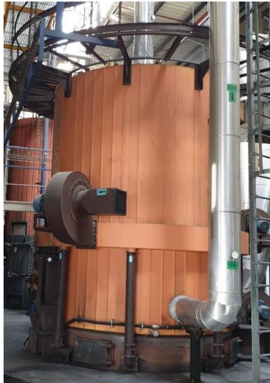
Figura 14 - Caldeira a biomassa de 4,6 MW
