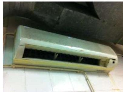
Figura 12 – Unidade interior do sistema split da lavandaria
