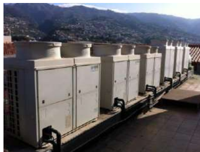
Figura 10 – Unidades exteriores do sistema VRF
