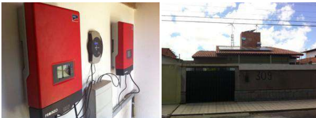
Figura 6 - Instalação Solar em Residência (Fortaleza)
