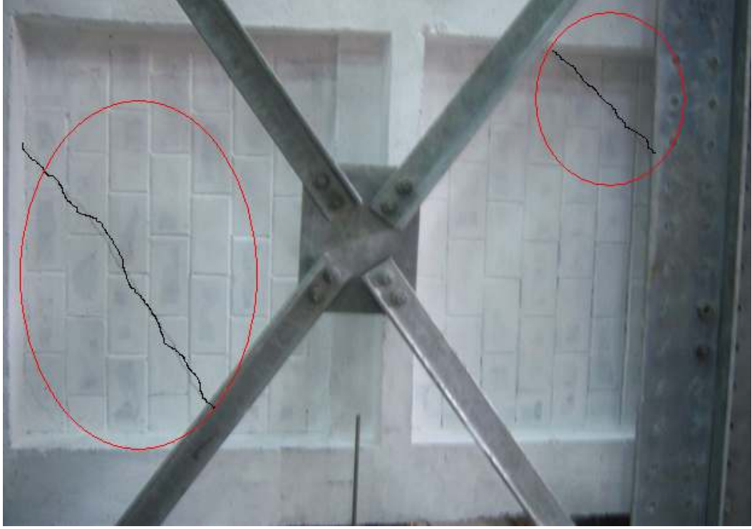
Şekil 5.57 S6 numunesi sağ çerçeve Kat.2 dolgu duvarında oluşan ilk çatlak.
