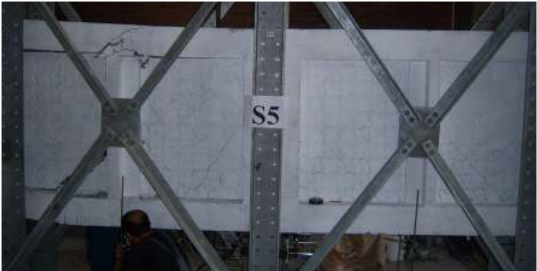
Şekil 5.49 S5 numunesi sol çerçeve Kat.2 kolon-kiriş birleşimi hasarı.
