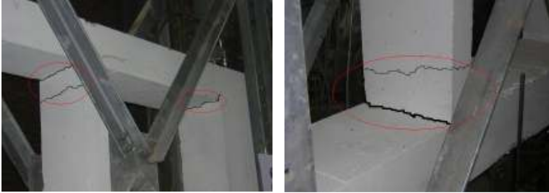
Şekil 5.10 S1 numunesi Kat.1 kolon-kiriş birleşim çatlakları
