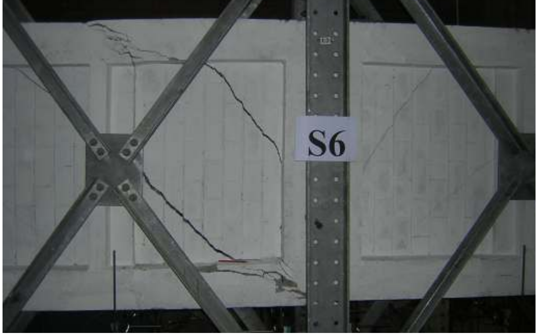
Şekil 5.59 S6 numunesi sol çerçevesinde oluşan dolgu duvar ve birleşim hasarı.
