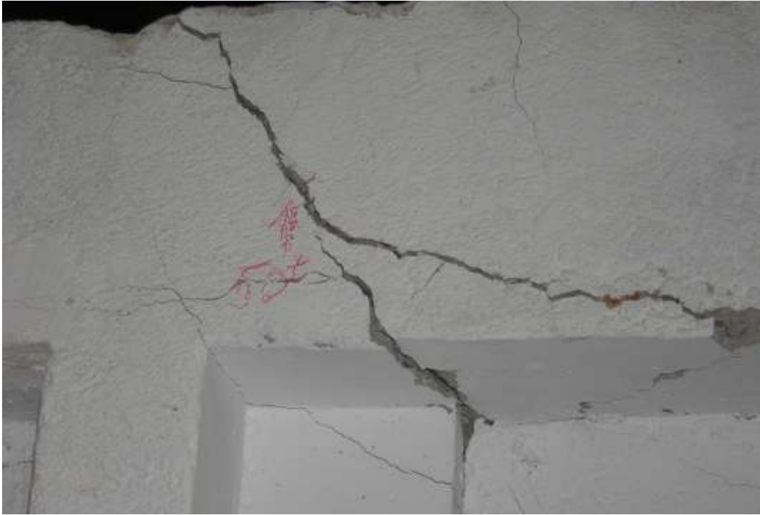
Şekil 5.20 Sol çerçeve kolonunda Kat.1 seviyesinde oluşan kesme çatlakları son hali.
