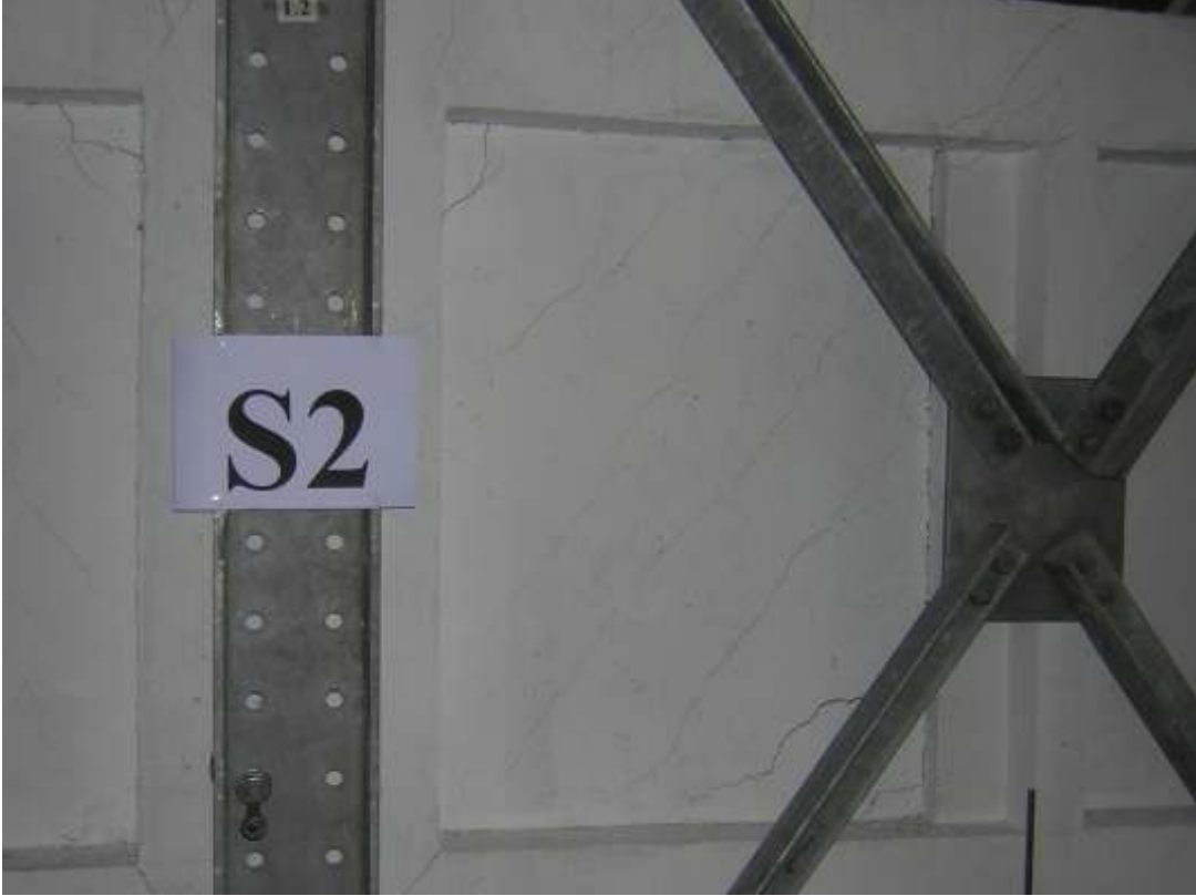
Şekil 5.18 Kat.1 betonarme dolgu duvarlarda oluşan diyagonal çatlaklar
