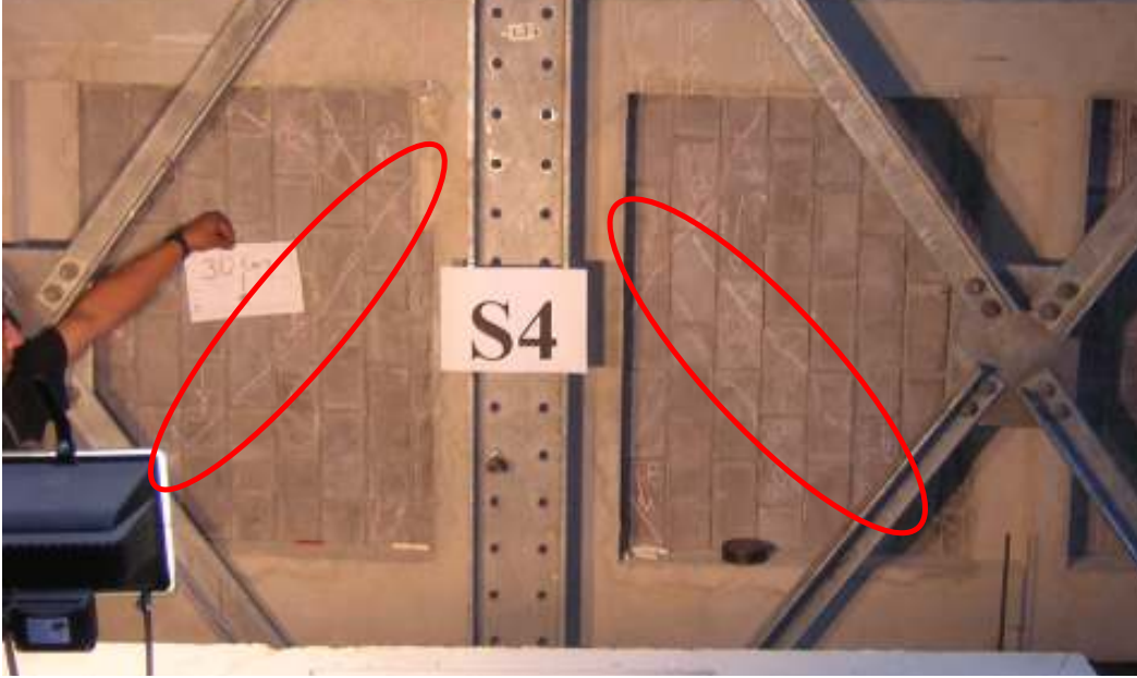
Şekil 5.36 S4 numunesi Kat.1 dolgu duvar ana diyagonal çatlakları.
