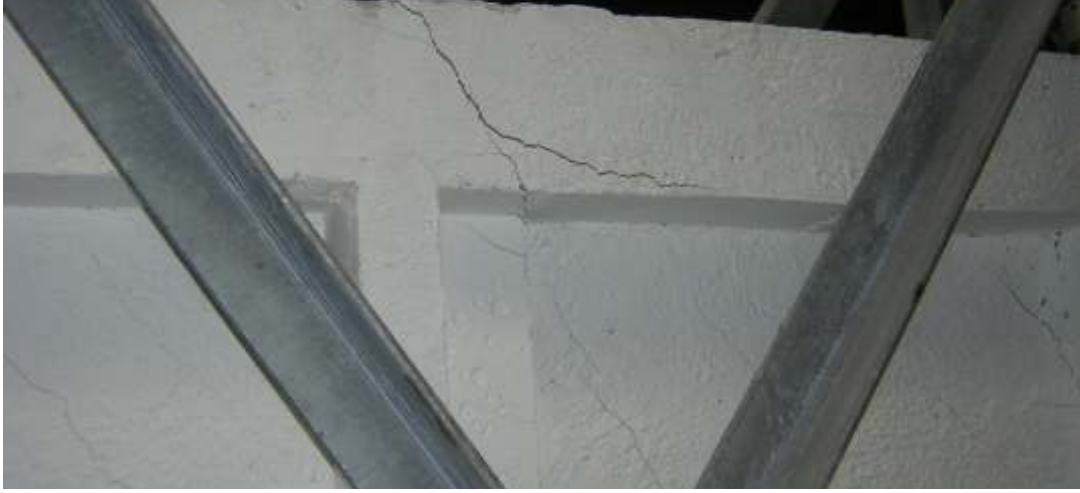
Şekil 5.19 Sol çerçeve Kat.1 kolon-kiriş birleşim bölgesinde oluşan kesme çatlakları
