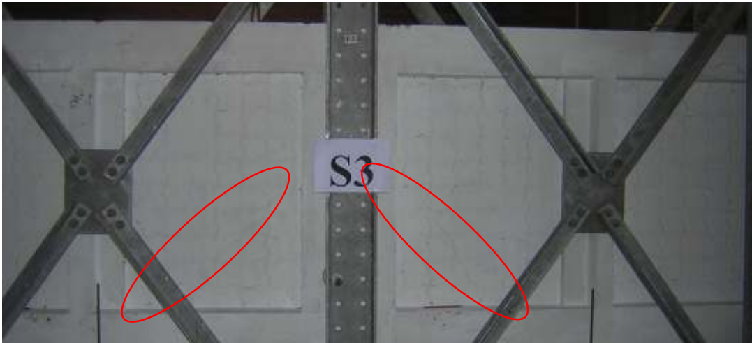
Şekil 5.26 Kat.1 dolgu duvarlarında ilk kılcal çatlaklar.
