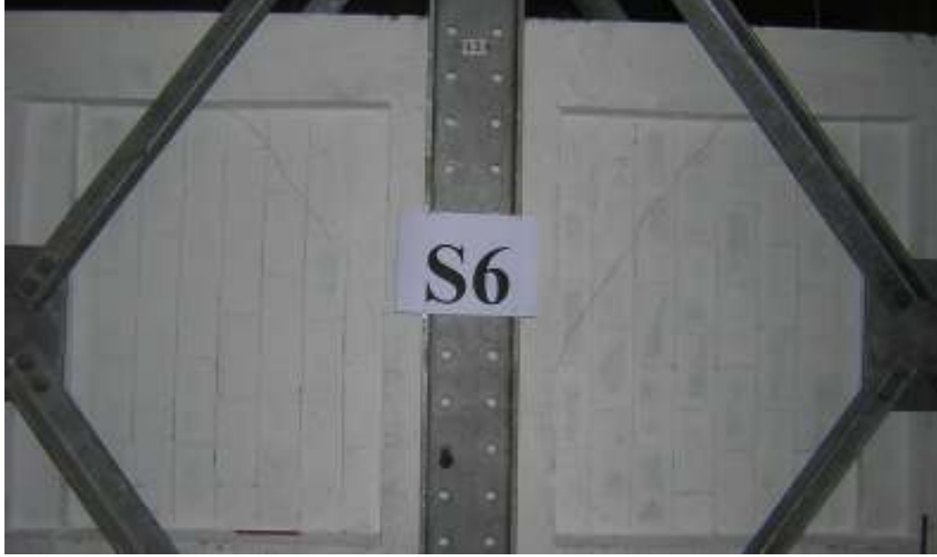
Şekil 5.56 S6 numunesinin Kat.1 dolgu duvarlarında oluşan çatlaklar.
