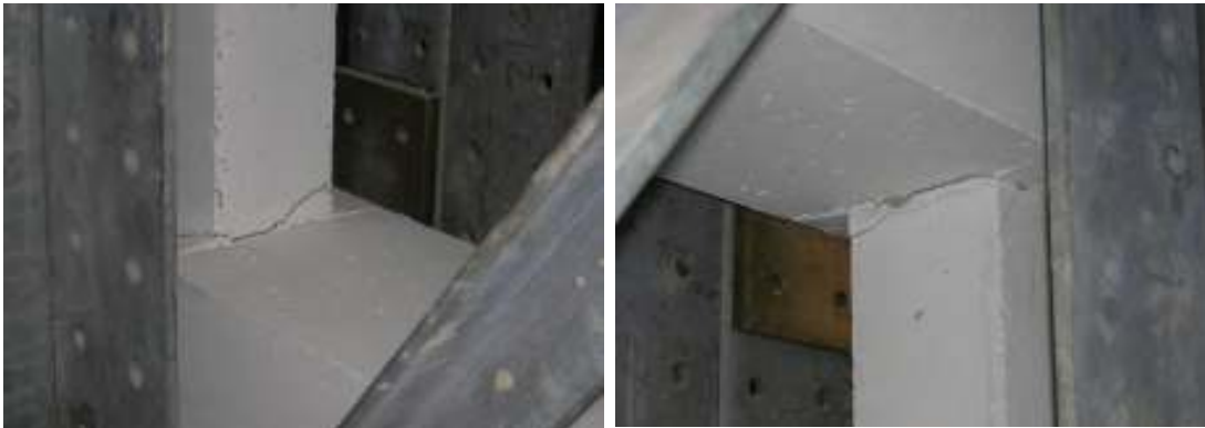
Şekil 5.11 Kat.2 kolon-kiriş birleşim bölgelerinde ileri boyutlara ulaşan açılmalar.
