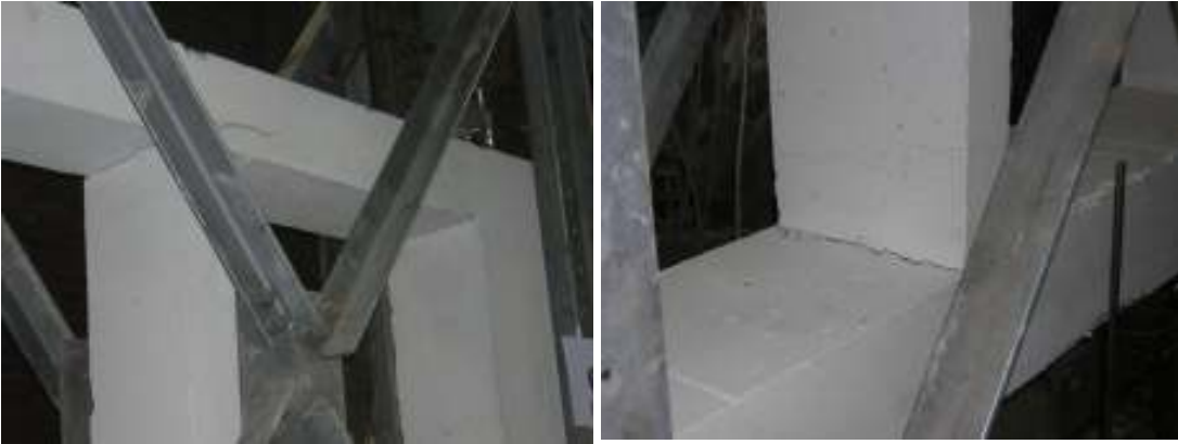
Şekil 5.8 S1 numunesi Kat.1 kiriş-kolon birleşimlerinin kolon yüzlerinde açılma.
