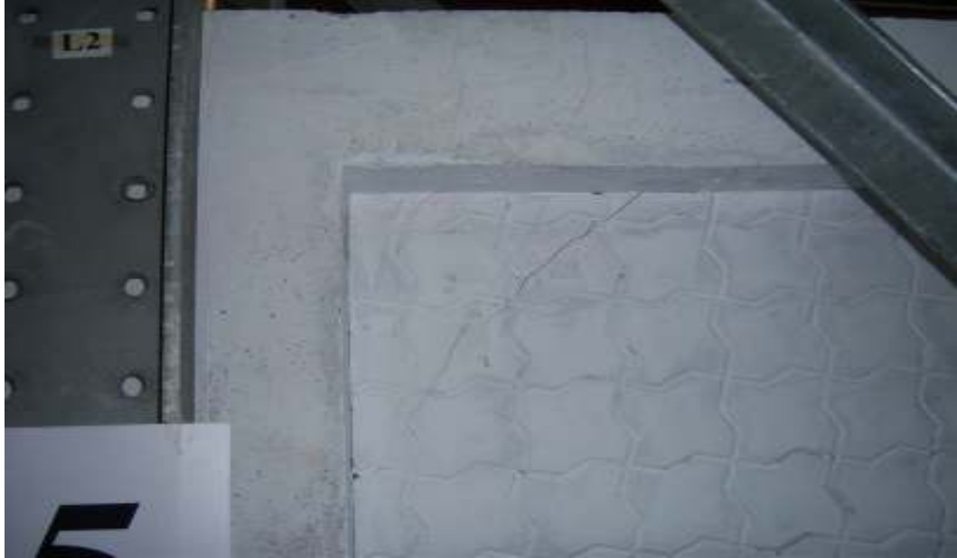
Şekil 5.44 S5 numunesi Kat.1 temel seviyesinde kolon eğilme çatlakları.
