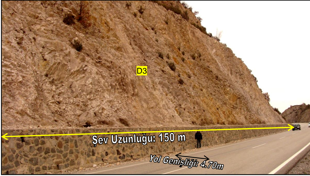
Şekil 4.12. Şev uzunluğu, yol genişliği ve DSD gibi parametrelerin gözlenebildiği şevin diğer kesiminden bir görüntü (Kuzeybatıya bakış). (AVR hesaplamasında gerekli olan şev uzunluğu bu şekilde verilen ile Şekil 4.11'deki şev uzunluğunun toplamıdır. Bunun nedeni ise şev yüzeyinden ayrılan kaya bloklarının tüm şev uzunluğu boyunca hem hendek içinde hem de yol üzerinde görülmesinden kaynaklanmaktadır. Ayrıca araçların geliş yönüne bakılırsa şeve girişte sürücülerin çizgisel bir yol izlemelerinden dolayı DSD (blok algılama mesafesi) uygun olarak alınmıştır.)
