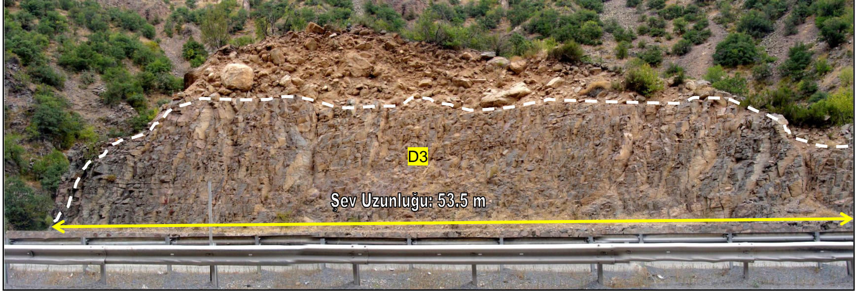
Şekil 4.27. A11 sınıfı şeve genel bir bakış (Kuzeydoğuya bakış). Kesikli çizginin altında kalan kaya yüzeyi dökülmeye duyarlıdır. Şevin taş kısmında yoğun bir yağış ile şevin tepesinden düşebilecek şekilde duran kaya blokları görülmektedir. Şev önü hendek oldukça dardır ve şevin tepesinden düşebilecek blokları tutma kapasitesinde olacağı kesinlikle düşünülmemektedir.
