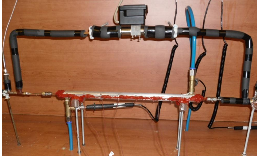
Şekil 21: Bakır borulu test kısmı
