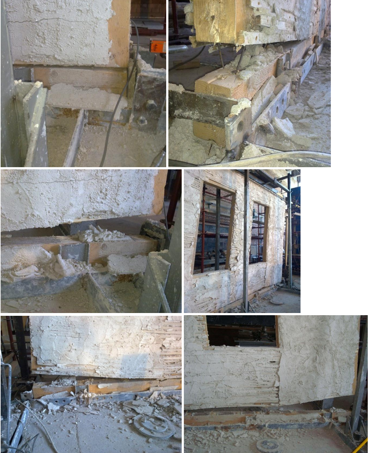
Şekil 303: Bağlantılarda meydana gelen hasarlara örnekler
