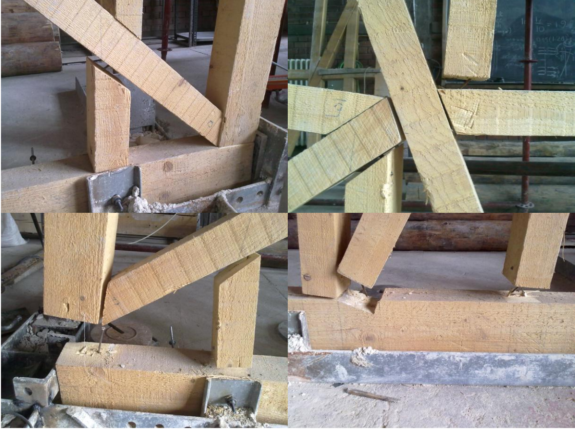
Şekil 143: Sekizinci çerçevenin boş halde test edilmesinin ardından bağlantılarda oluşan kalıcı açılmalar
