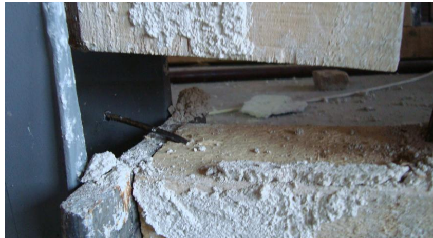
Şekil 282: Çerçeve bağlantılarında oluşan hasar görünümü
