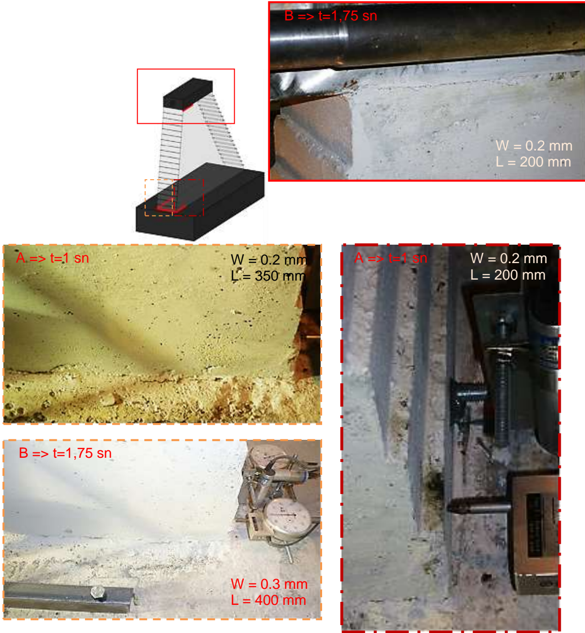
Şekil 61. OBE Depremi Esnasında Oluşan Çatlaklar
