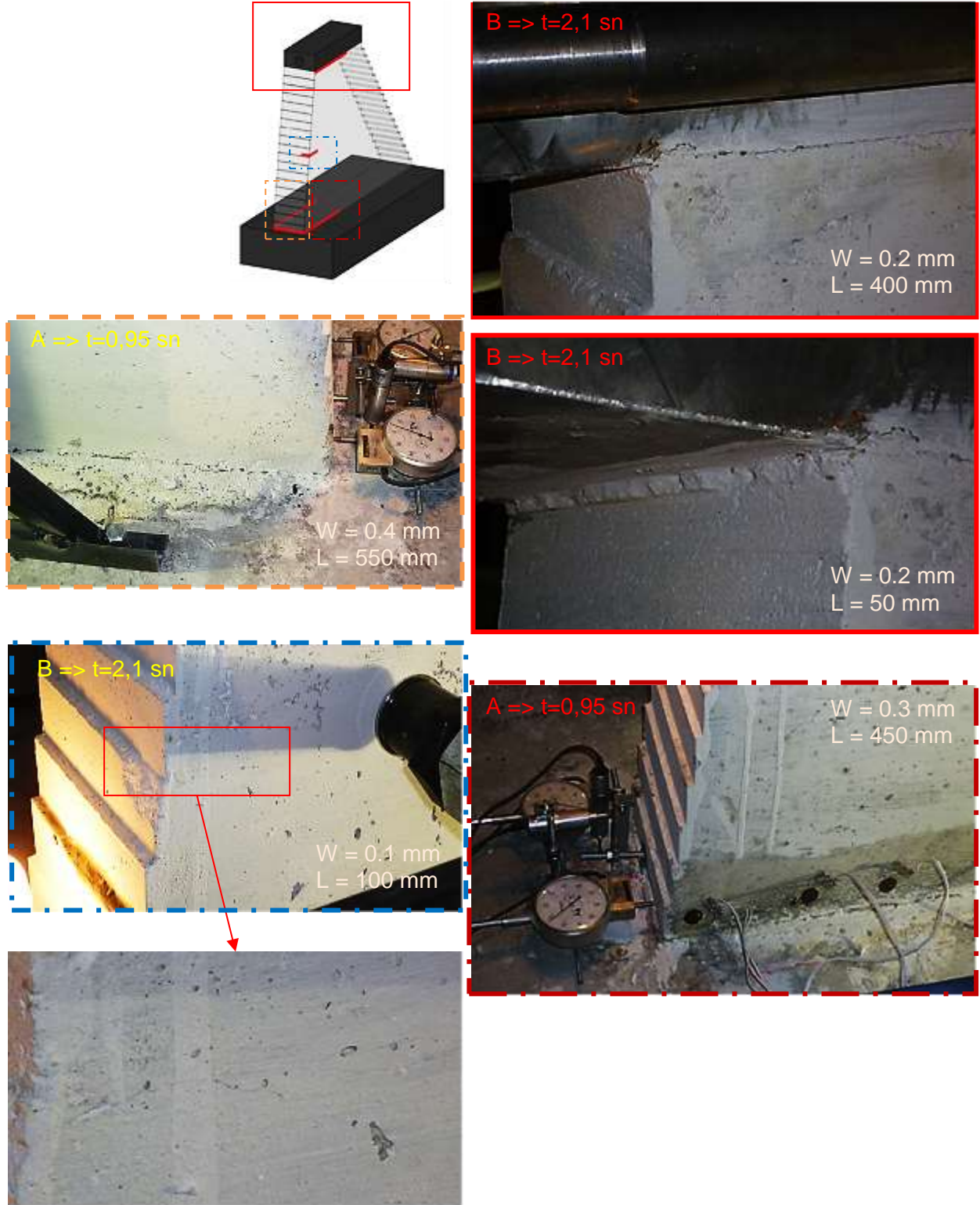
Şekil 67. MDE Depremi Esnasında Oluşan Çatlaklar
