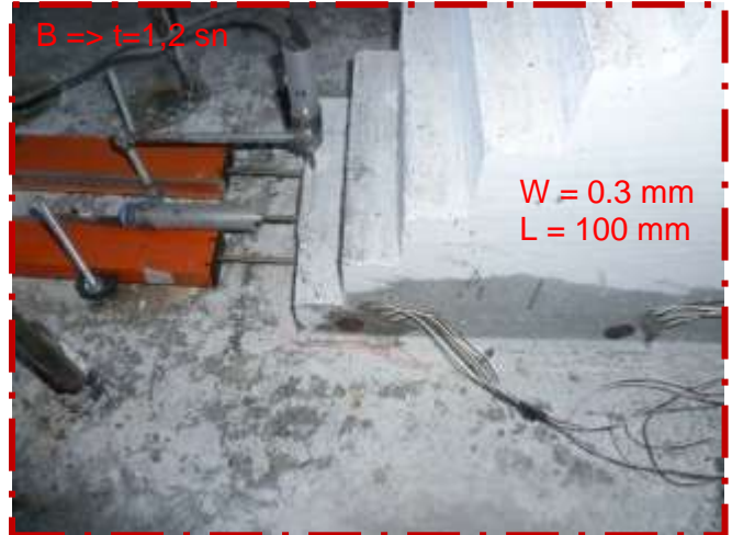
Şekil 126. MCE Depremi Esnasında Oluşan Çatlaklar 2
