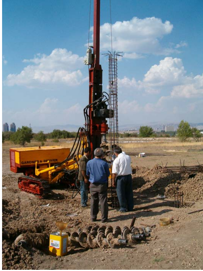
Şekil 2.7 Kazık deliklerinin delgi makinası ile açılması ve donatı kafesinin vinç yardımıyla deliğe yerleştirilmesi
