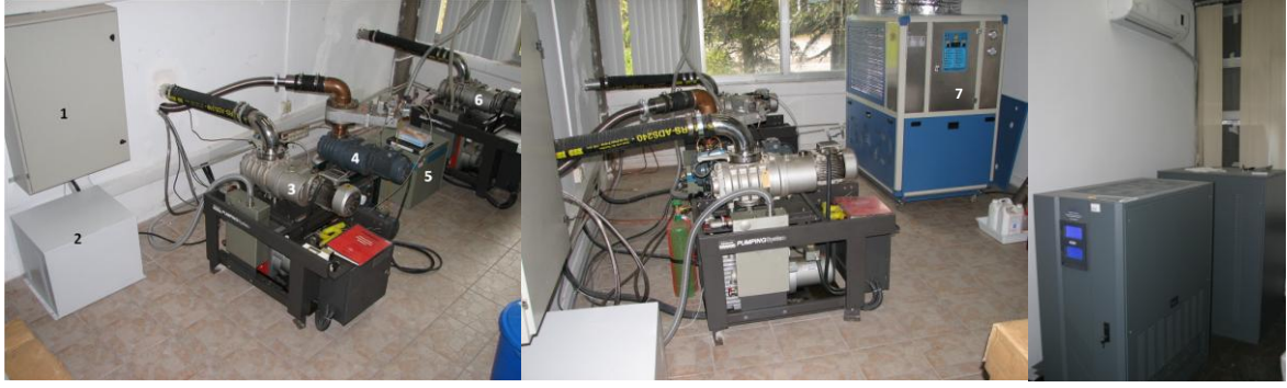
Şekil 7 HAK sisteminin (Makine odası) Ekim 2008 tarihli görüntüsü (sağdaki iki resim). (1): Elektrik panosu, (2): Trafo, (3): 1 ve 2 numaralı vakum odacıklarını besleyen mekanik pompa seti, (4): 3 numaralı vakum odacığını besleyen mekanik pompa seti, (5): Kapalı devre helyum soğutucularını besleyen kompresör, (6): Bolometre detektörü besleyen mekanik pompa seti, (7): Difüzyon pompaları ve helyum kompresörü için soğutma suyu temin eden soğutucu ünitesi. Sisteme sonradan takılan 80 KVA'lık kesintisiz güç kaynağının görünümü (soldaki resim)
