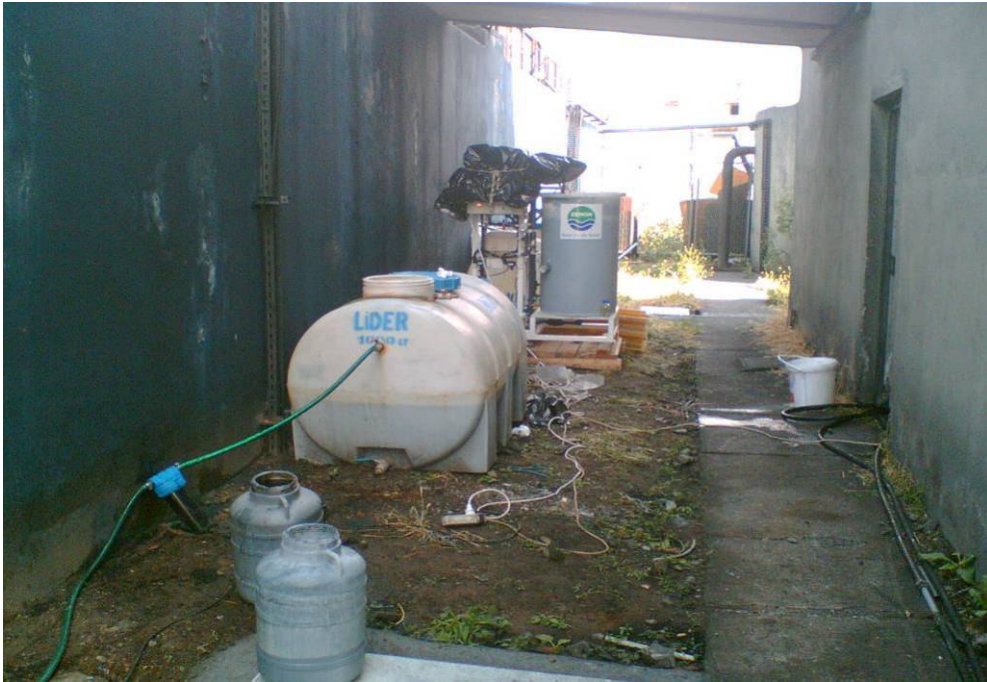
Şekil 49. Atıksu iletim hattı, kartuş filtre ve 1000 L'lik atıksu besleme tankı
