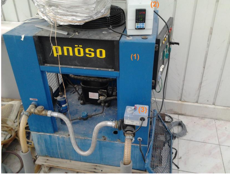
Şekil 5.1 Soğutma ünitesi: (1) Soğutucu pompa (2) Kontrol ve gösterge kutusu (3) Kontrol vanası.
