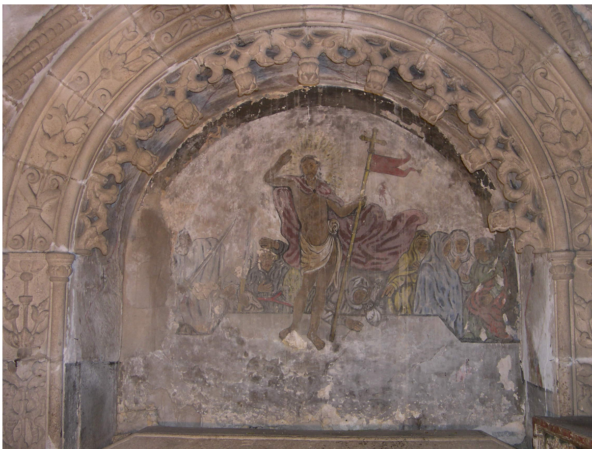
Figura 1 - Pintura mural antes da intervenção
