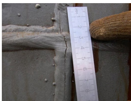
Рисунок 1.14 – Трещина вдоль сварного шва
