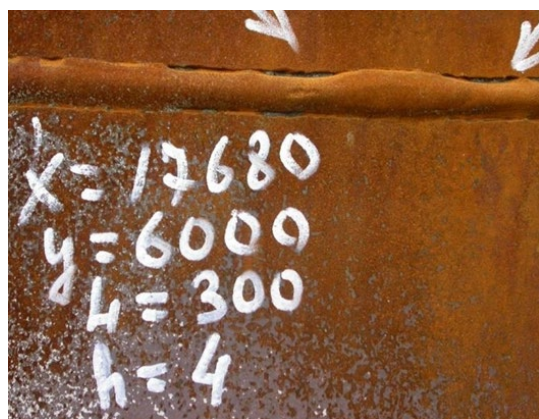
Рисунок 1.12 – Подрезы сварного шва
