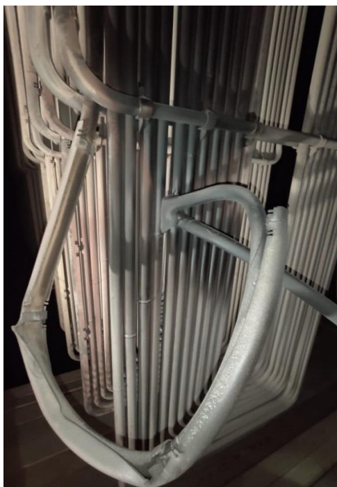
Рисунок 13 – Пример разрыва трубки ширмового пароперегревателя
