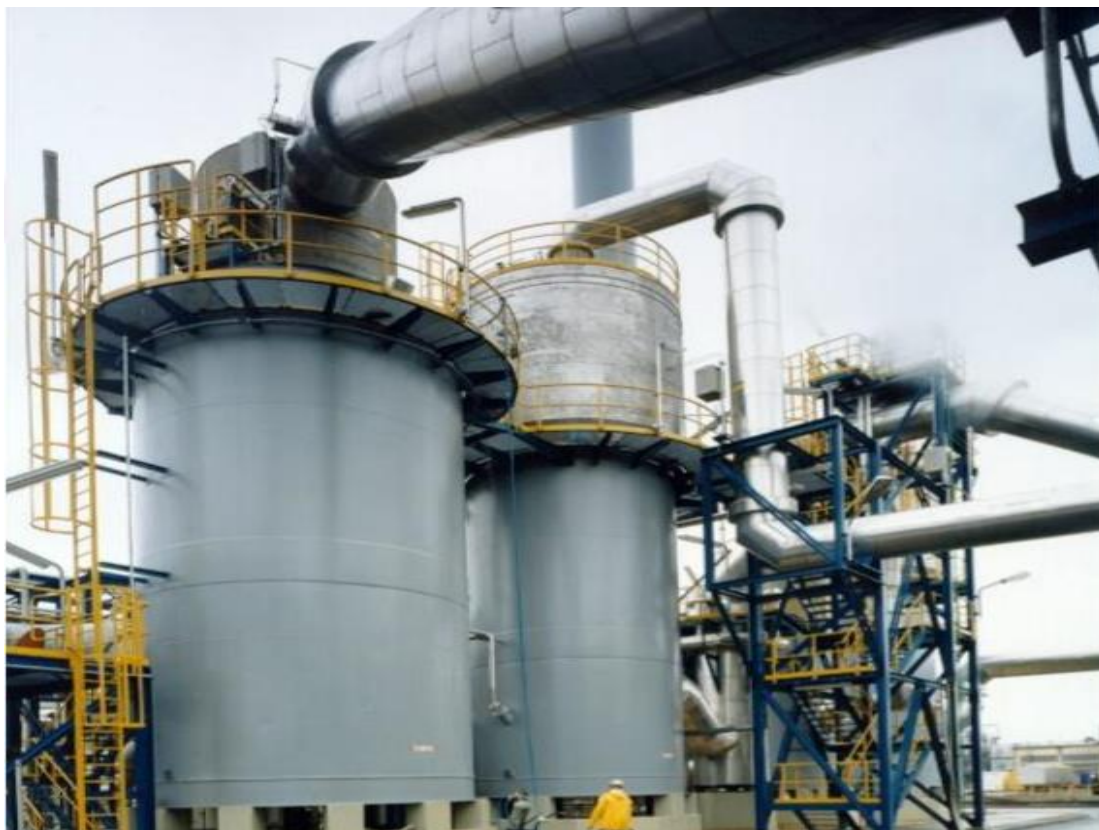
Рисунок 2.4 – Абсорбционная и сушильная башни: «Outotec GmbH» которые находятся в эксплуатации, АО «Алмалыкский ГМК»
