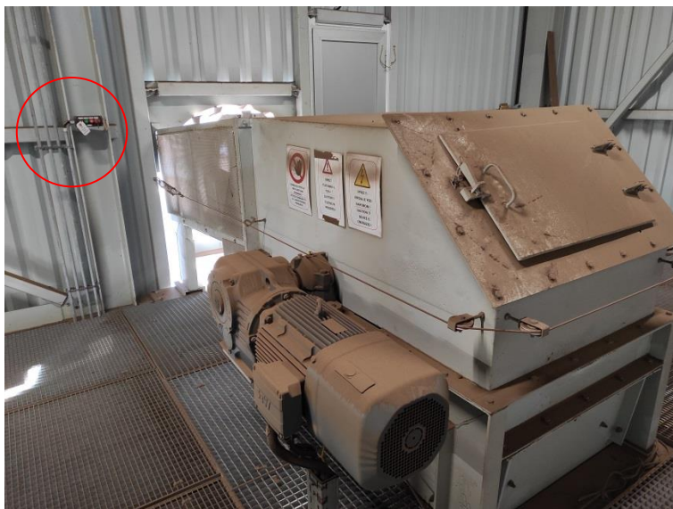
Slika 7.2: Lokacija lokalnega panela ob transporterju G-1
