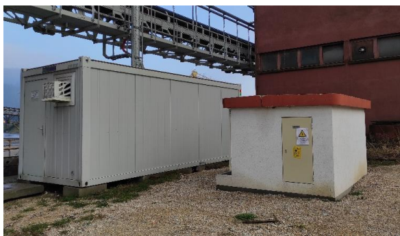
Slika 5.3: Presipna postaja – levo kontejner K1 in desno transformatorska postaja TS1
